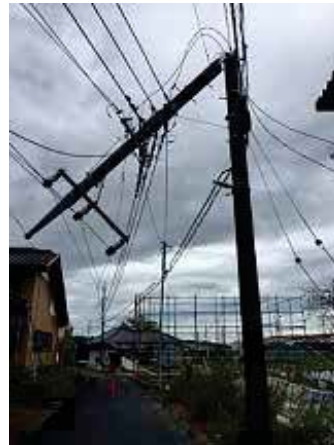
千葉県内の 暴風による被害
