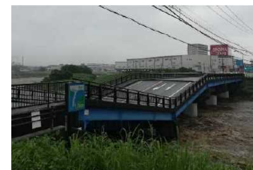
黄瀬川大橋の被害（静岡県沼津市）
