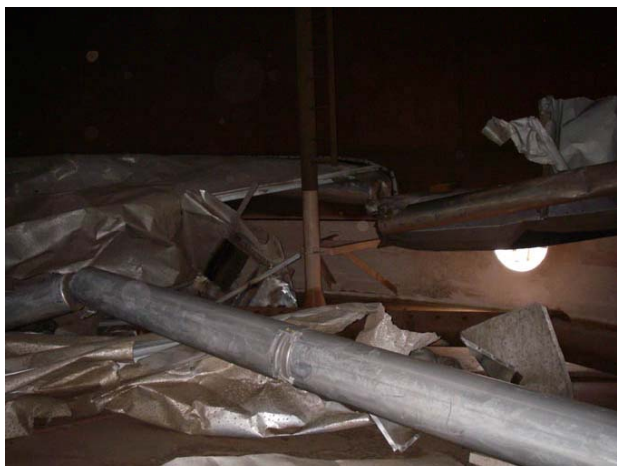
ゲージポール近傍の破損浮き蓋散乱状況
