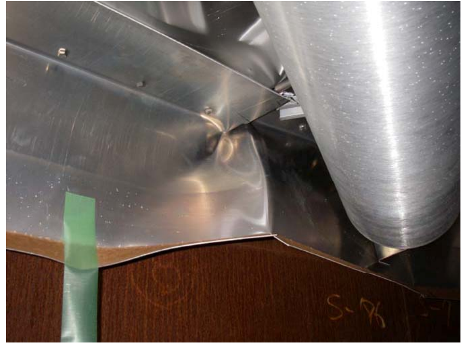
アルミ製内部浮き蓋の破損
