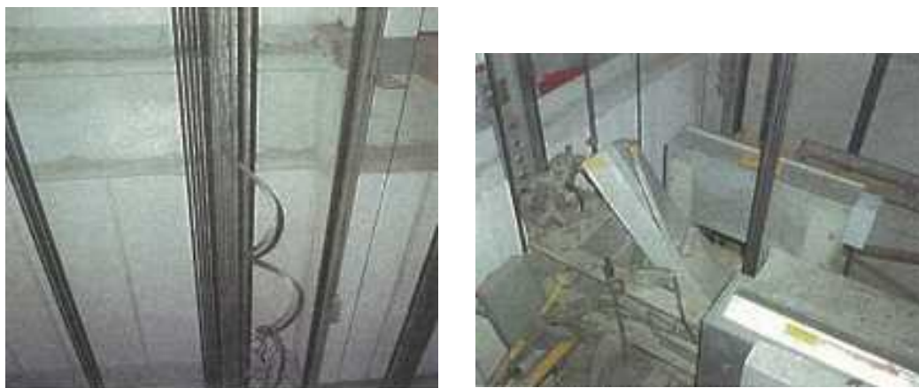
図 6 エレベーターの主索周辺の損傷事故（主索切断）[写真左]と長尺物の接触により着床装置破損等[写真右]の事故例
