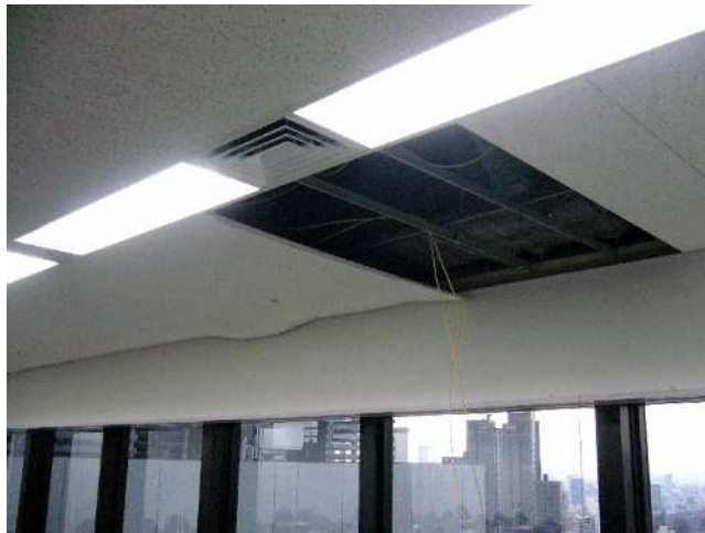
28F (天井パネルの落下)
