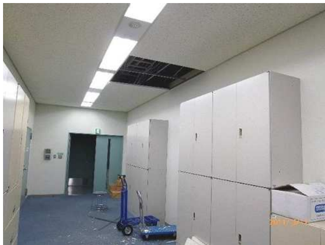
14F (天井パネルの落下)
