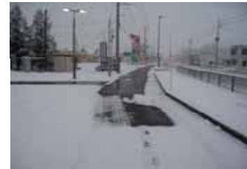
融雪施設の点検・整備
