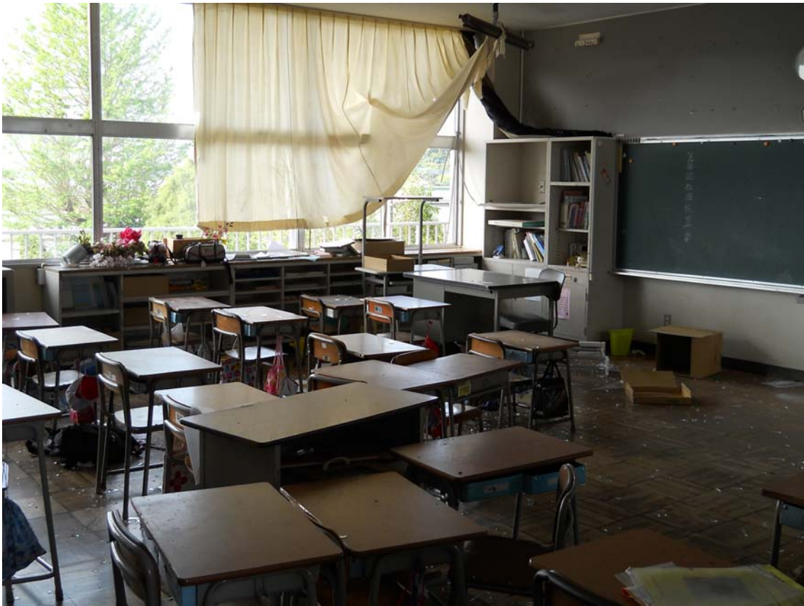
5月6日竜巻における 西田井小学校室内被害状況写真
