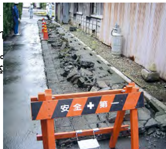
駿河湾を震源とする地震(平成21年8月11日発生)によるブロック塀の倒壊
