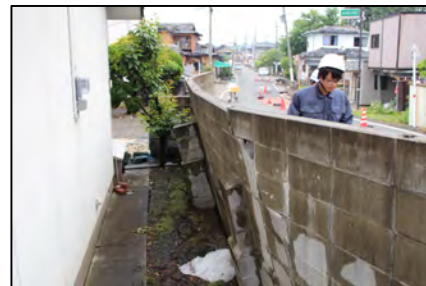
〔控壁により倒壊しなかったブロック塀（熊本地震）〕
