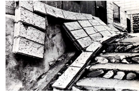
← 1978年宮城県沖地震 死者28名中18名がブロック塀等の下敷き 写真は仙台市「78宮城県沖地震災害の記録」から
