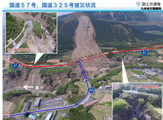
平成28年(2016年)熊本地震による阿蘇大橋付近の被害 九州地方整備局「阿蘇大橋地区復旧技術検討会(第1回)」資料から
