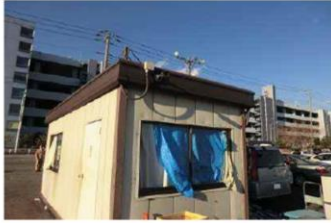
① 飛散物により窓ガラスが破損したプレハブ施設
