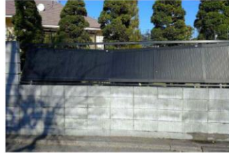
④ 倒壊したフェンス
