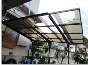
②屋根パネルが破損したカーポート
