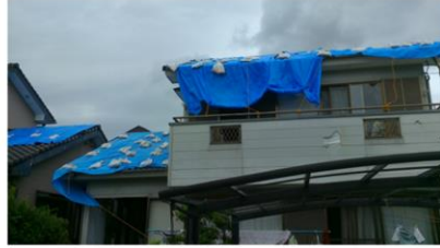
屋根が損壊した住宅 2
