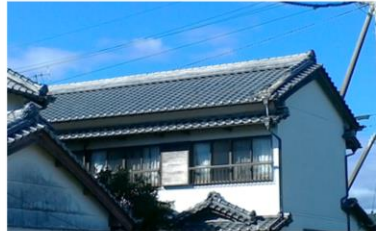
屋根瓦が飛散した住宅
