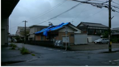
屋根が損壊した住宅 1
