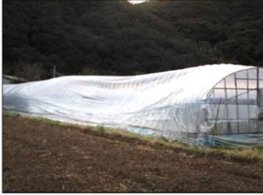
①鋼管が変形した農業用ハウス
