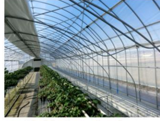
④鋼管が変形したパイプハウス 90
