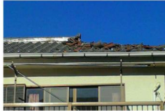
③ 屋根瓦がめくれた住家
