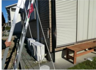
③一部破損した住家と壁の戸
