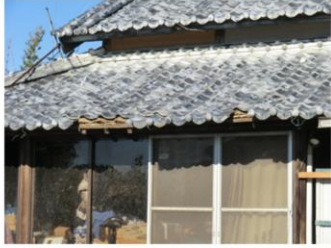
①煉瓦と軒先瓦が破損した住家
