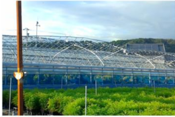
鋼管が変形したパイプハウス1
