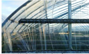
鋼管が変形したパイプハウス2
