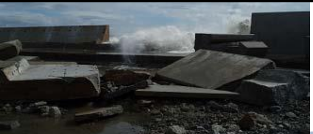
護岸一部損壊 (久慈市) 写真：岩手県提供
