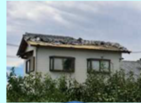
突風被害例 (住家の屋根瓦の飛散)
