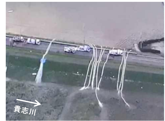
【和歌山県:紀の川水系貴志川(国管理)】 丸栖地区での排水ポンプ車による支援
