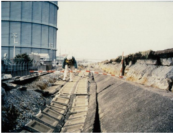
液状化による高潮堤防の崩壊(淀川)
