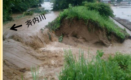
秋田県 大仙市 斉内川の堤防決壊状況
