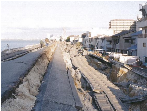
液状化による高潮堤防の崩壊(淀川)
