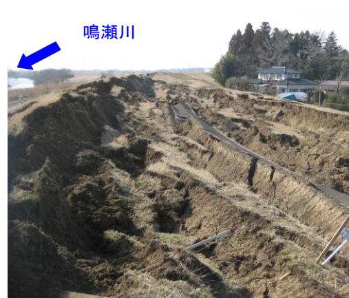
液状化による河川堤防の崩壊(鳴瀬川)
