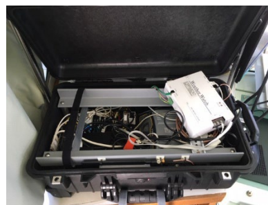
図 7-2-20 格納ボックス内部。 ロガー兼通信装置（上部 の白い装置）、その下に GNSS受信機を収納
