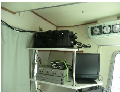
図 7-2-19 後部操舵室に設置した ボックスにGNSS受信器、 通信機を格納
