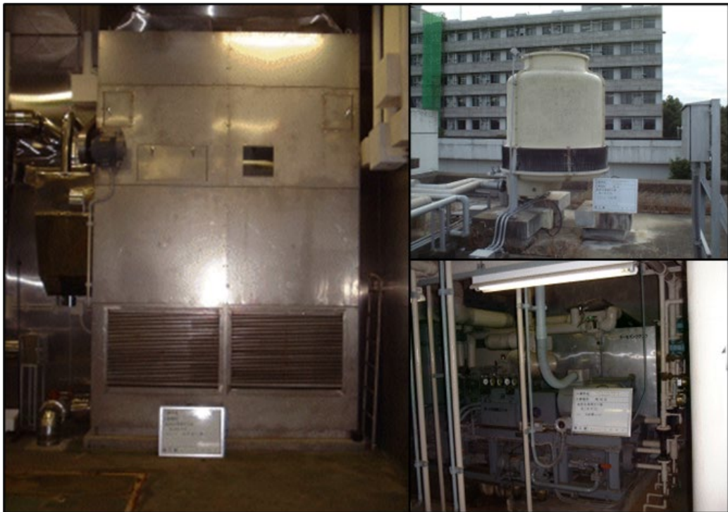
図 7-2-3 ・平成14年改修前の-30℃低温室の室内（左） ・冷却塔（屋上）（右上） ・水冷式スクリーユ冷凍機（機械室）（右下）
