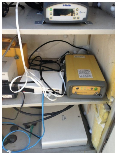
図 7-2-16 筐体内部 中段右にGNSS受信機（オレンジ色の装置）、その左はネットワークHUB、下段に光通信の端末（白い筐体）を収納した。
