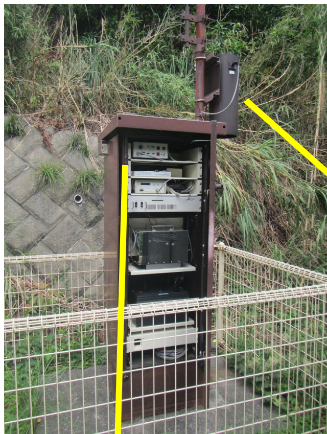
空振計設置筐体
