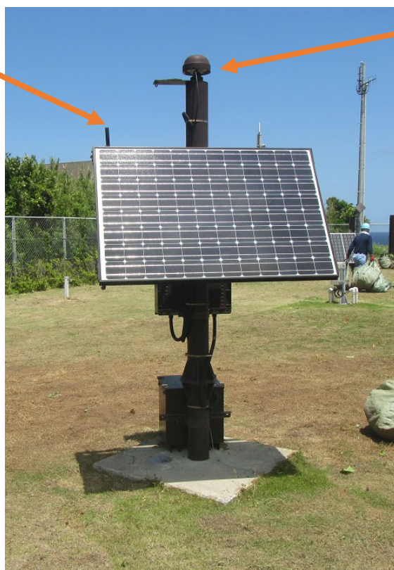
GNSS観測装置（太陽電池タイプ）
