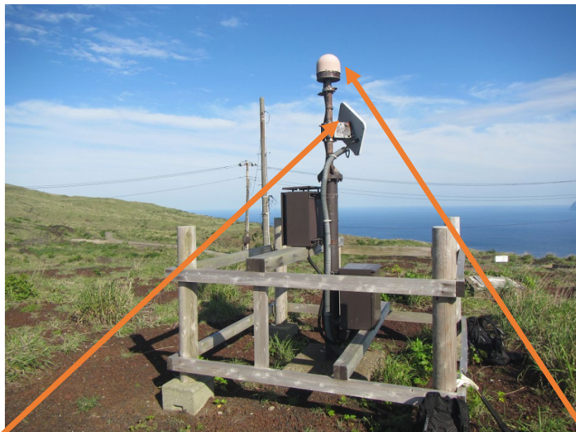
GNSS観測装置（商用電源タイプ）
