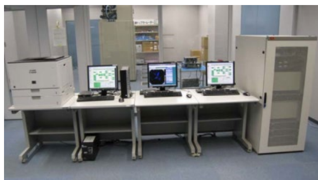
図 3-2-26 レーダーデータ処理装置、 保守監視装置
