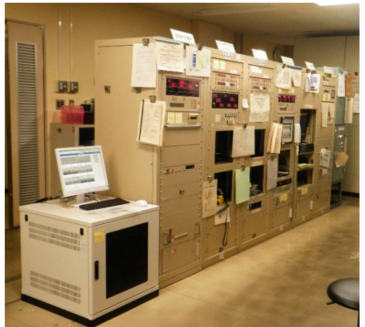
空港気象常時監視通報装置
