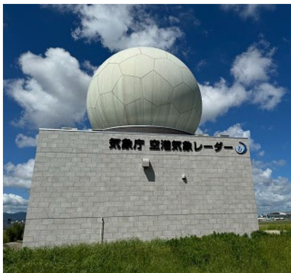
図 3-2-23 福岡DRAW（令和元年度に二重偏波DRAW運用開始、令和4年度に局舎移設）
