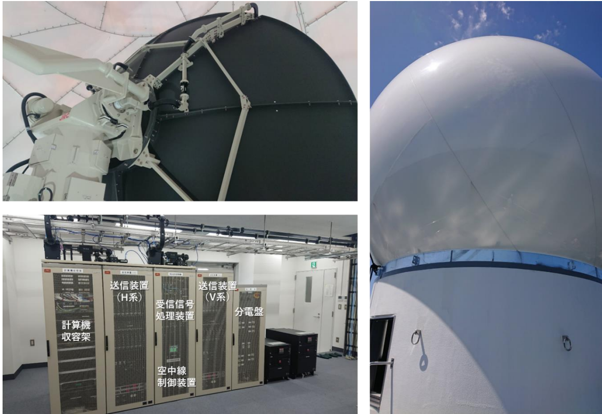
付録写真3 一般気象レーダーの主要装置の主な外観（日本無線株式会社製）
