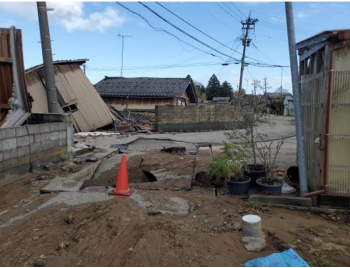
写真3-6 家屋の倒壊と路面の陥没
