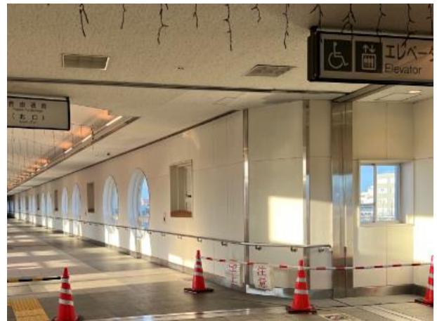
写真3-53 自由通路の天井落下 (上越市東町、直江津駅)
