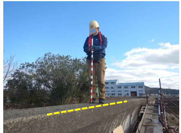
写真3-132 越水箇所 (図3-42 ⑦-6)
