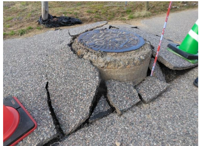
写真3-12 マンホールの隆起
