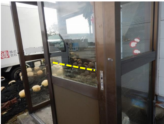
写真3-88 津波の痕跡 (図3-20 ⑤-1)
