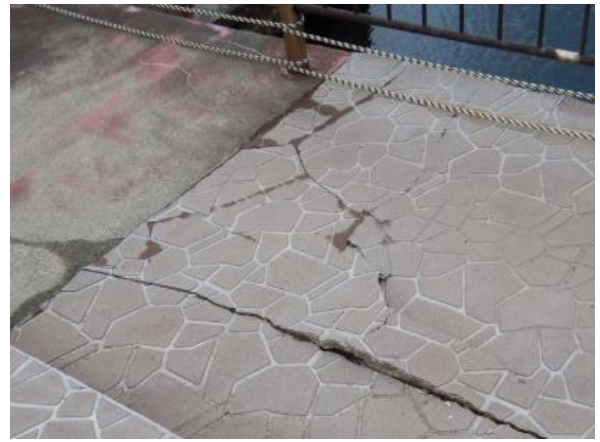
写真3-57 みなと公園護岸付近の亀裂 (佐渡市小木町、小木港)
