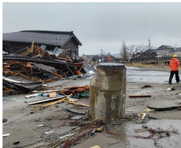
写真3-84 液状化により浮き上がった マンホール (珠洲市鵜飼漁港)
