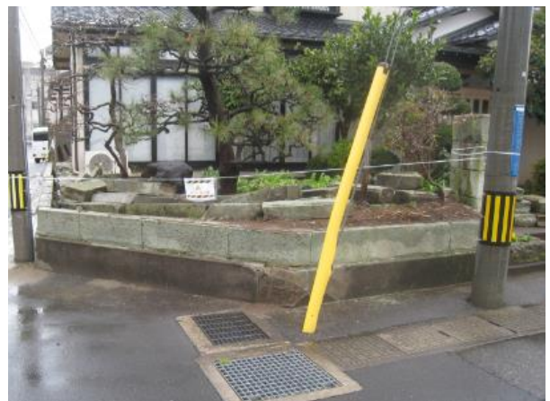
写真3-40 ブロック塀の倒壊
