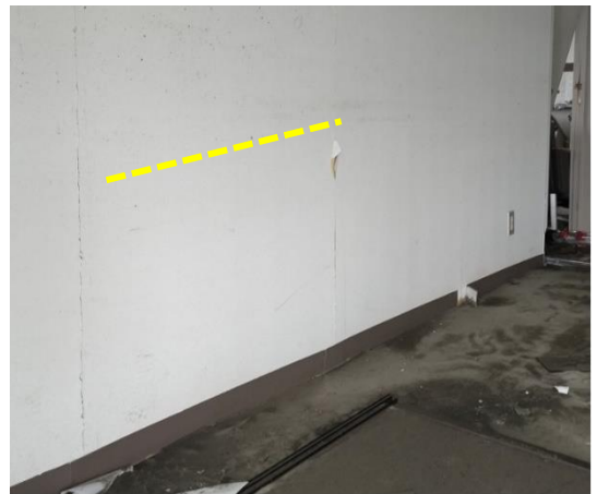
写真3-78 津波の痕跡 (図3-18 ②-1)
