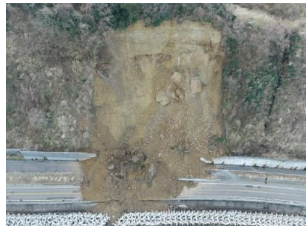
写真3-55 国道8号線沿い土砂崩れ (上越市茶屋ヶ原) 北陸地方整備局提供
