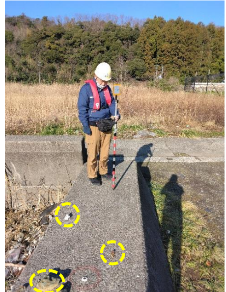
写真3-130 津波の痕跡(漂流物確認) (図3-42 ⑦-4)
