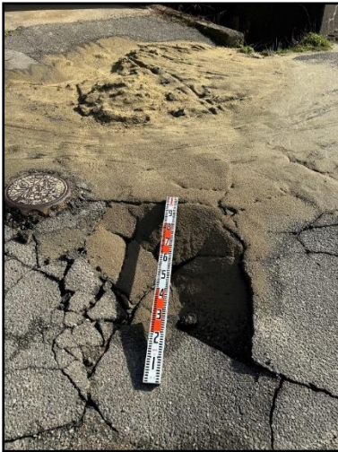
写真3-13 液状化による地盤沈下
