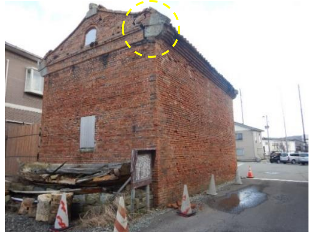
写真3-64 外壁損傷と屋根瓦の落下 (佐渡市相川柴町大間港レンガ倉庫)
