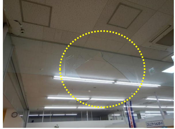
写真3-28 防煙垂壁の破損
