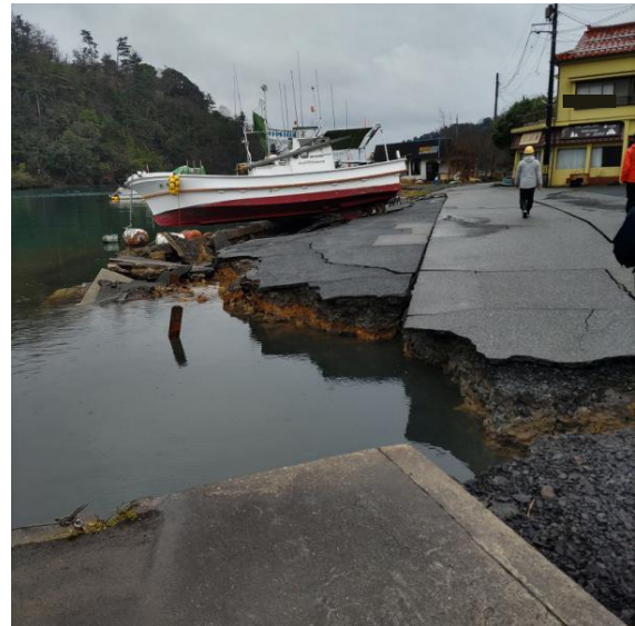
写真3-101 岸壁の破損、岸壁に打ち上げられた船
