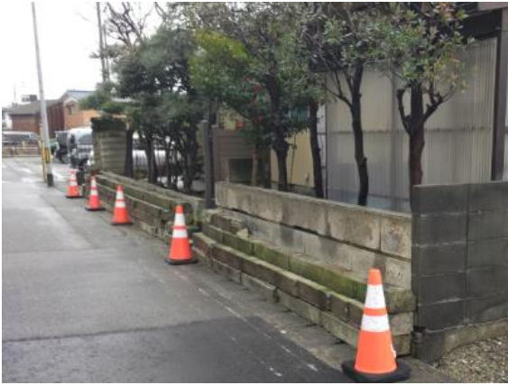
写真3-41 大谷石塀の倒壊
