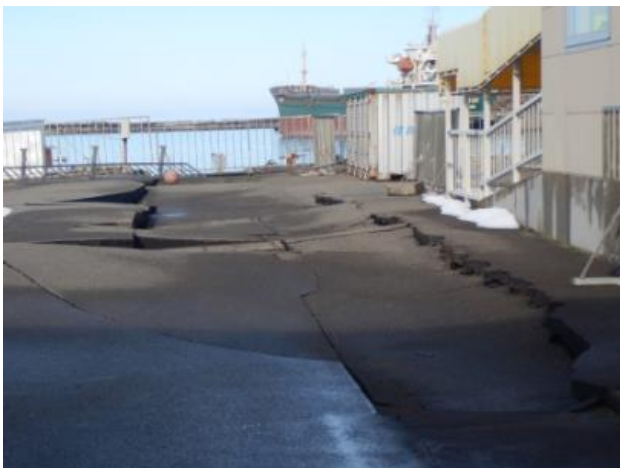
写真3-52 埠頭舗装の亀裂・陥没 (上越市港町一丁目、直江津港)
