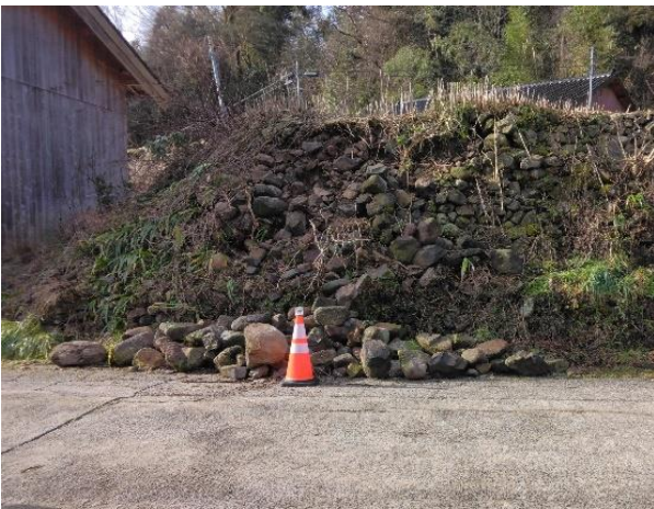
写真3-62 石積み法面の崩落 (佐渡市西三川)
