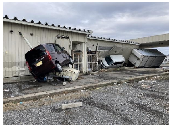
写真3-77 津波により流された車
