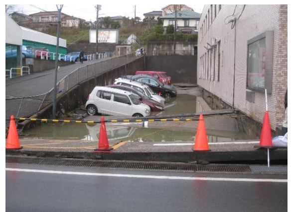
写真3-47 液状化による駐車場の泥水噴出 と沈下(新潟市西区寺尾朝日通)
