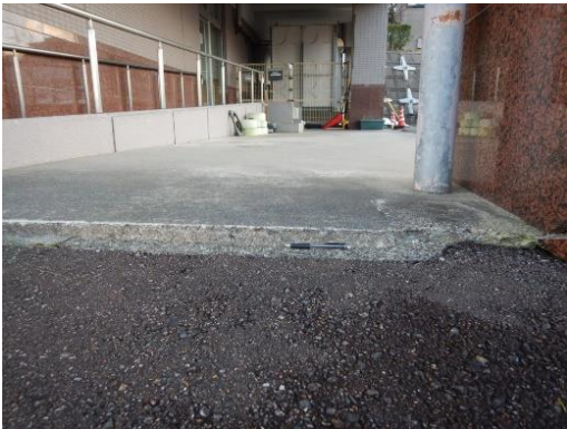
写真3-31 建物基礎の段差
