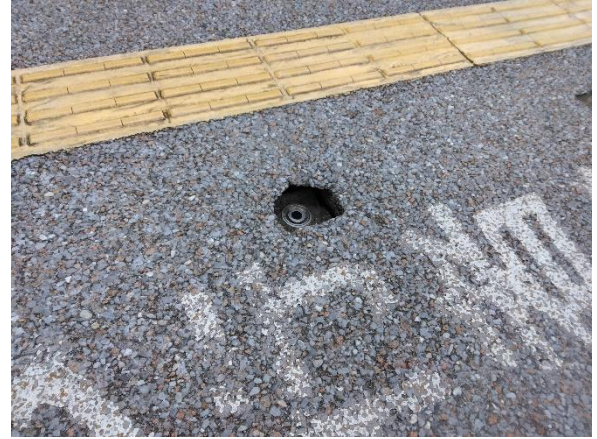
写真3-17 融雪装置の陥没
