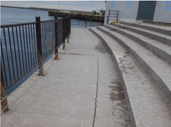
写真3-56 みなと公園護岸付近の亀裂 (佐渡市小木町、小木港)
