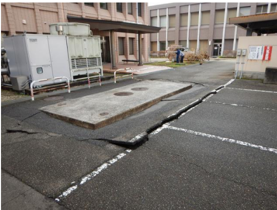
写真3-20 路面の亀裂・段差
