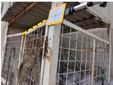
写真3-76 津波の痕跡 (図3-17 ①-4)
