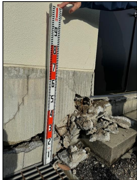
写真3-15 階段の崩壊と外壁の剥離・亀裂
