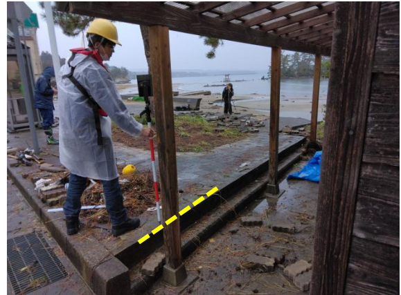
写真3-87 津波の痕跡 (図3-19 ④)
