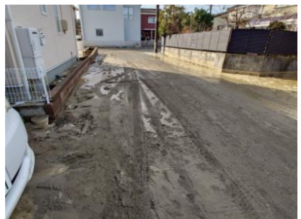
写真3-49 路面の泥水噴出と噴砂跡 (新潟市西区山田)
