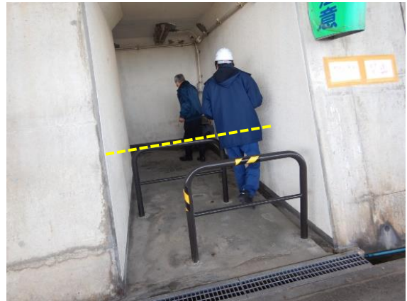
写真3-112 津波の痕跡 (図3-29 ①)
