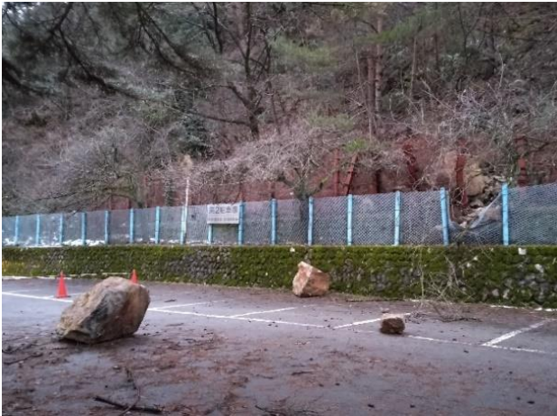
写真3-63 落石によるフェンスの損傷 (佐渡市下相川金山第二駐車場)
