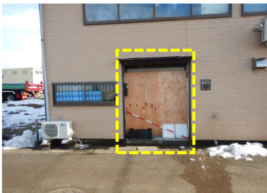
写真3-119 玄関ドアの破損 (上越市港町)
