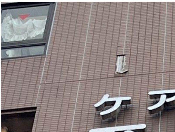
写真3-54 外壁の剥離 (上越市東雲町二丁目)
