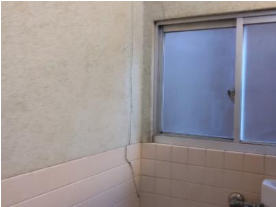
写真3-43 家屋内壁の亀裂
