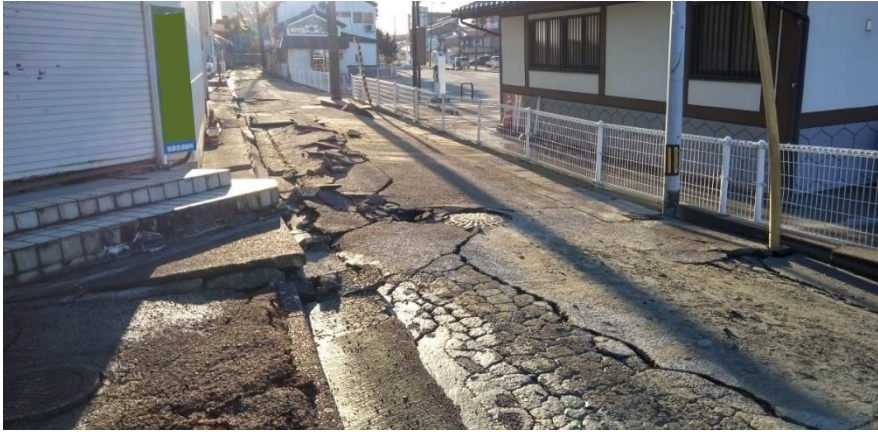
写真3-71 路面の亀裂・段差
