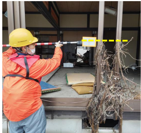
写真3-90 津波の痕跡 (図3-21 ⑥)
