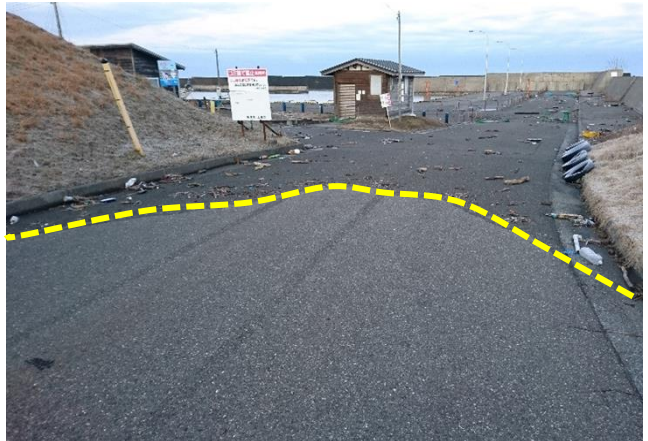
写真3-116 津波の痕跡 (図3-36 ①) (相村建設(株)提供)
