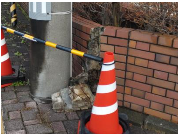
写真3-32 レンガ塀の破損
