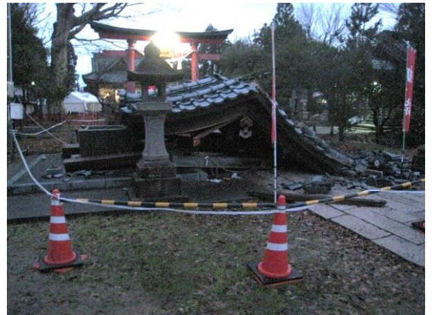
写真3-51 手水舎の倒壊 (新潟市西蒲区曾根)
