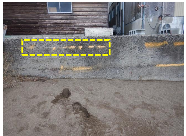
写真3-128 津波の痕跡 (図3-42 ⑦-2)
