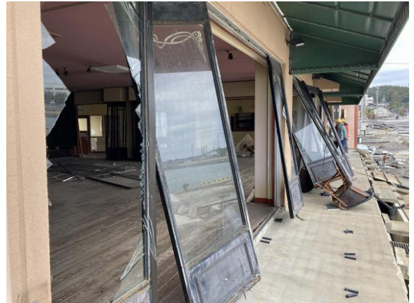
写真3-75 津波による浸水被害 (図3-17 ①-3)
