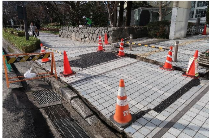
写真3-68 路面の亀裂、段差
