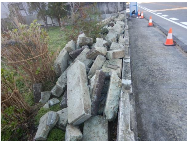
写真3-69 ブロック塀の倒壊
