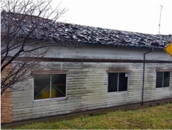
写真3-2 屋根瓦の破損
