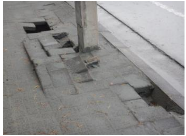
写真3-66 路面の陥没・噴砂跡 (佐渡市両津湊港湾道路歩道)
