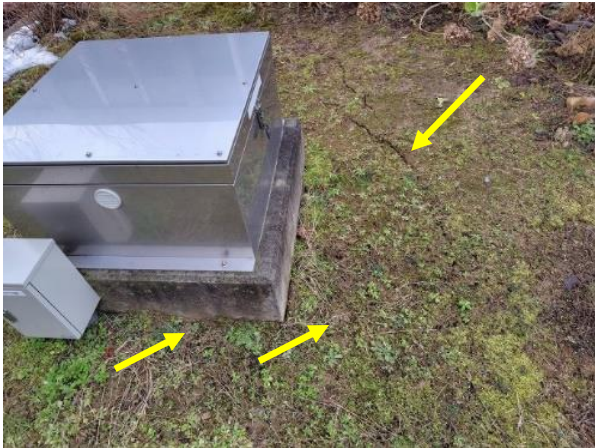
写真3-18 震度計周囲の亀裂 矢印部分が確認された亀裂
