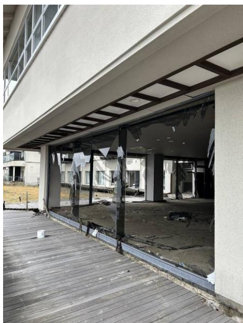
写真3-85 津波の浸水被害 (珠洲市見附海岸)
