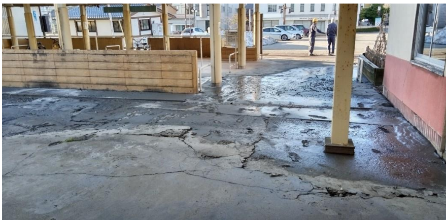
写真3-72 液状化現象の痕跡 (JR伏木駅)
