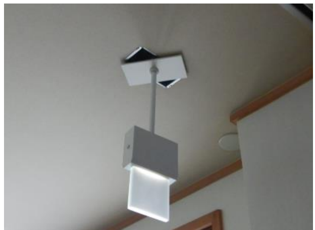
写真3-30 誘導灯の損傷
