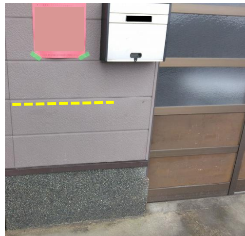
写真3-102 津波の痕跡 (図3-24 ⑨)
