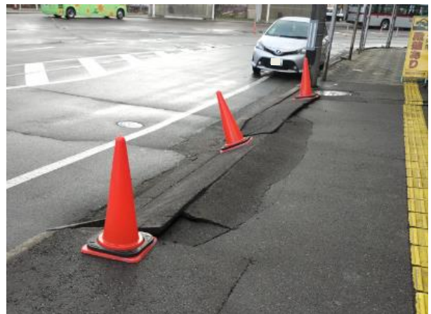
写真3-33 路面の亀裂・陥没
