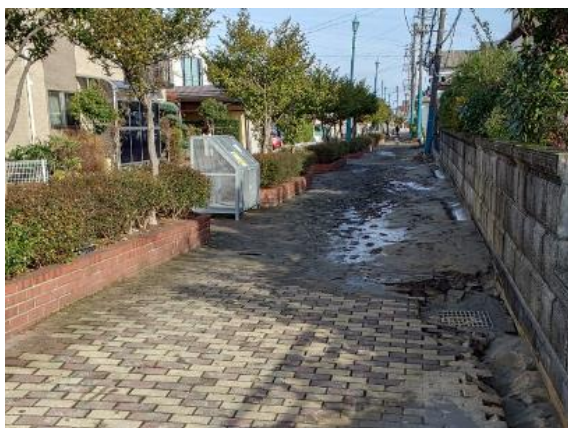
写真3-48 路面の泥水噴出と沈下 (新潟市西区山田)
