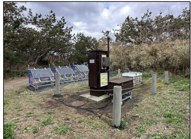
写真7-2 ソーラー給電化後の状況（輪島市舳倉島観測点）
