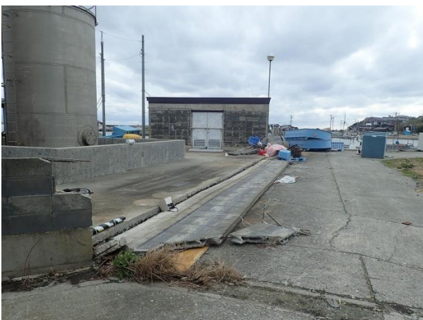
写真3-108 ブロック塀の倒壊
