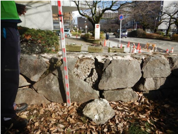
写真3-67 石垣の一部破損
