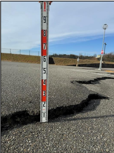
写真3-14 段差を伴う亀裂
