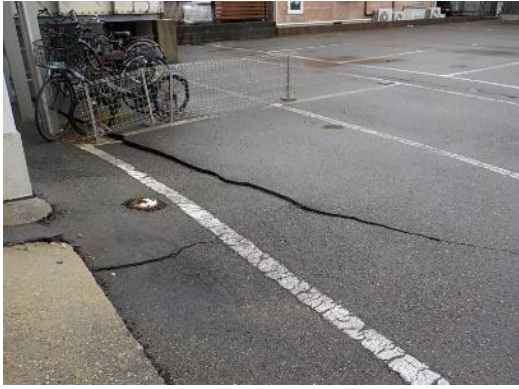
写真3-36 駐車場路面の亀裂
