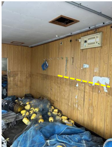
写真3-79 津波の痕跡 (図3-18 ②-2)
