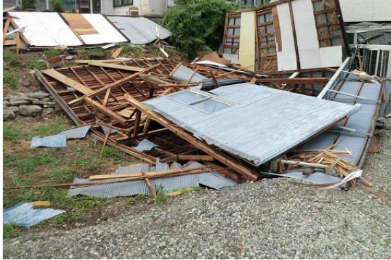
倒壊した物置 (8月2日 栃木県芳賀町)
