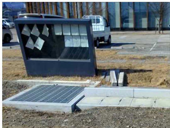
写真3-15 役場敷地内の屋外掲示版の傾き
