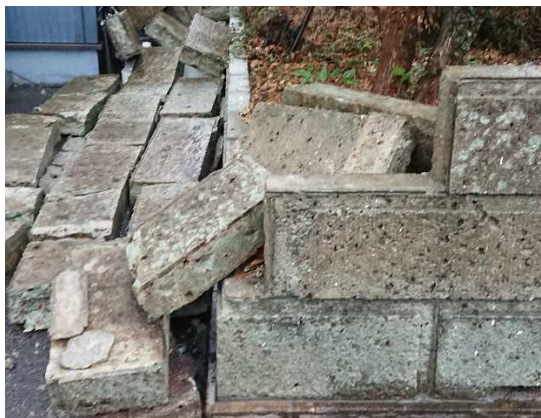
写真3-19 民家の塀の倒壊
