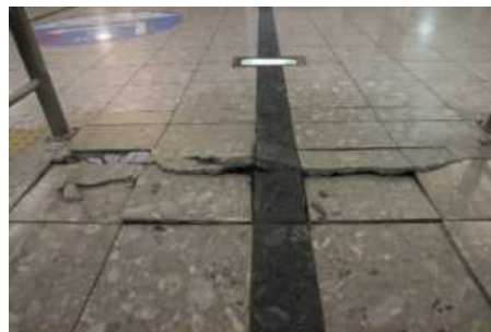
写真 3－9 床のタイルの割れ （仙台空港（株）撮影）
