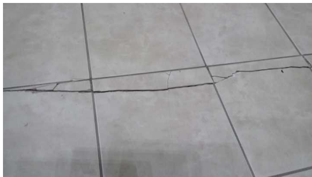
写真3-30 建物床材の亀裂
