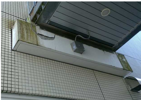
写真3-16 庁舎外壁のモルタル剥離
