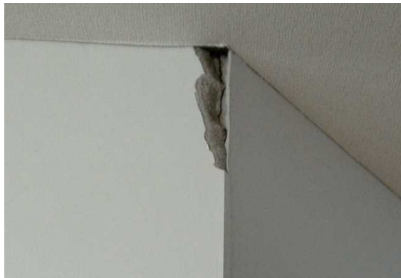
写真3-24 建物内壁の破損
