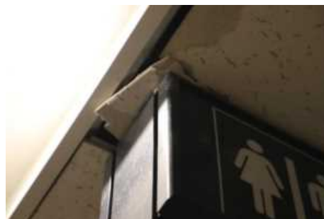
写真 3－10 天井パネルの剥離 （仙台空港（株）撮影）
