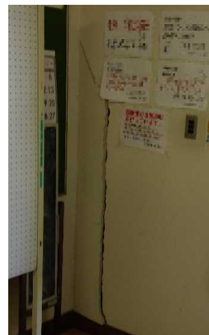
写真3-27 建物内壁の亀裂
