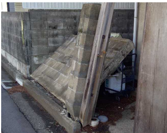
写真3-26 補強されていないブロック塀の倒壊
