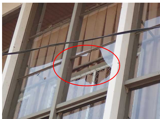
写真3-31 窓ガラスの落下（上：広域、下：狭域）
