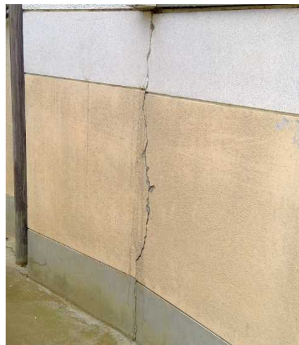
写真3-32 建物外壁の亀裂
