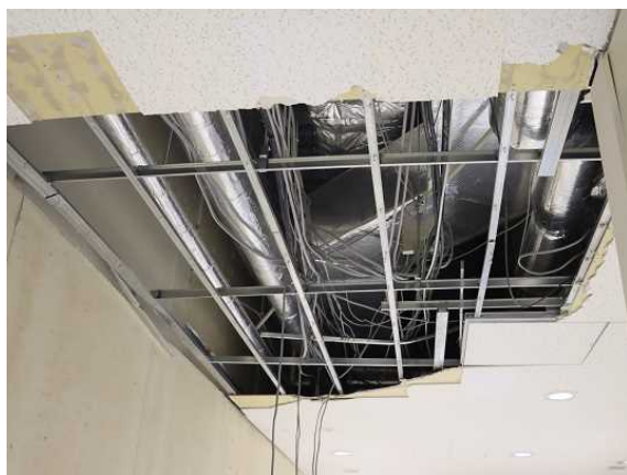
写真3-18 庁舎天井の破損 (落下)
