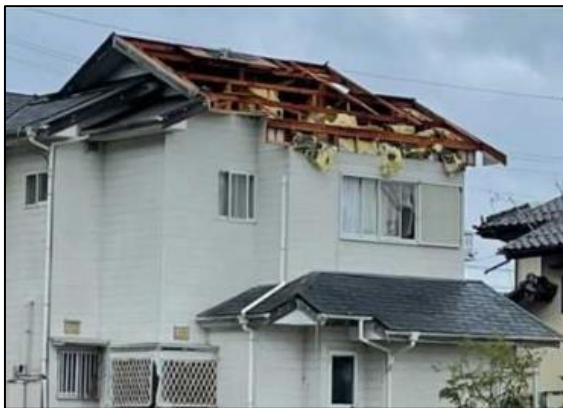
屋根の野地板が飛散した住家 （8月17日の岐阜県加茂郡八百津町の被害：②）
