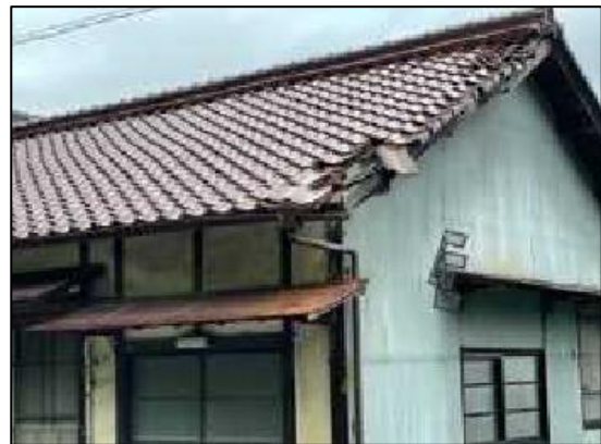
屋根瓦の一部が飛散した非住家 （8月17日の岐阜県加茂郡八百津町の被害：②）
