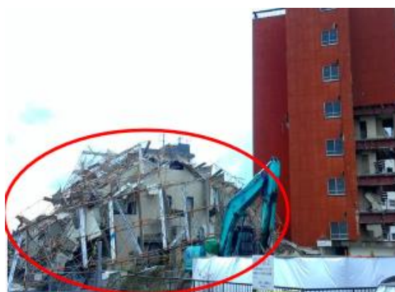
倒壊した工事現場の足場 （7月11日の栃木県佐野市の被害：④）
