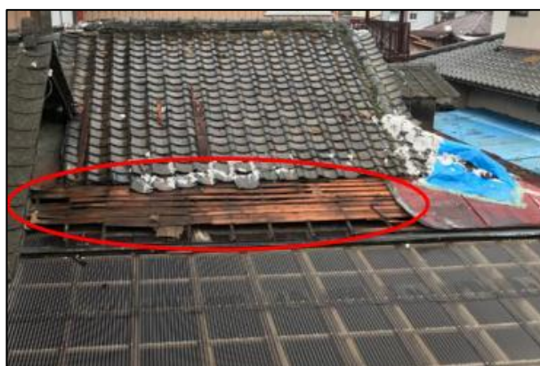
トタンが飛散した住家 （7月11日の群馬県桐生市の被害：④）
