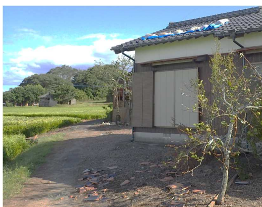
木造住家の屋根瓦のめくれ
