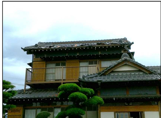
屋根瓦がめくれた住家 （7月25日の埼玉県三郷市の被害：⑯）
