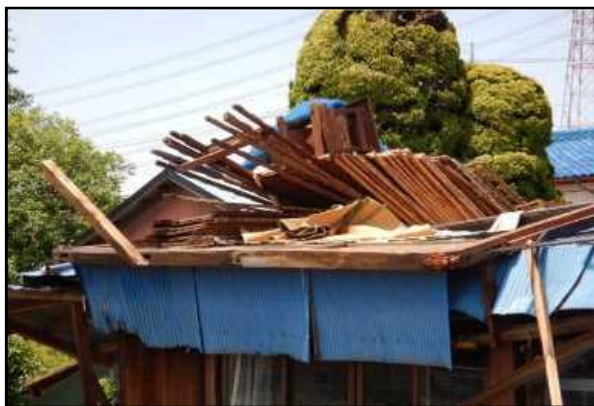
破損した非住家 （6月6日の群馬県伊勢崎市の被害：③）
