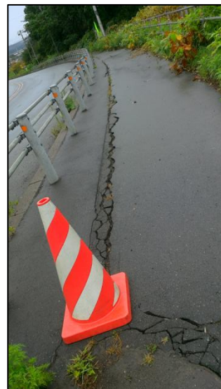
写真 40 道路の亀裂 (日高町富川南 2 丁目)
