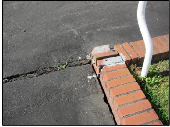
写真 14 ブロックとアスファルトの隙間広がる (安平町早来北進)
