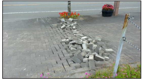
写真12 歩道の亀裂 (厚真町京町)
