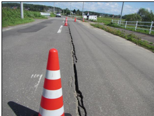
写真 34 道路亀裂 (安平町中安平橋付近)
