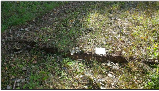
写真21 地盤の段差 (安平町追分柏が丘)
