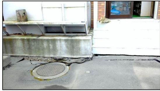
写真 24 舗装のひび割れ (むかわ町美幸)
