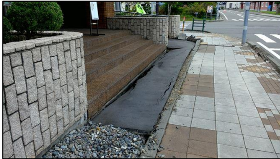
写真 25 舗装のひび割れ (むかわ町美幸)
