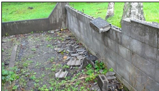
写真 36 ブロック塀の崩落 (平取町振内町)
