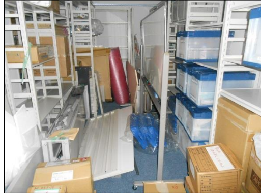
写真 50 倉庫内の棚板の落下
