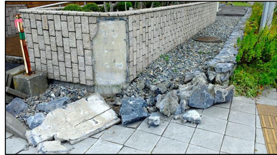
写真 26 塀壁の崩落 (むかわ町美幸)
