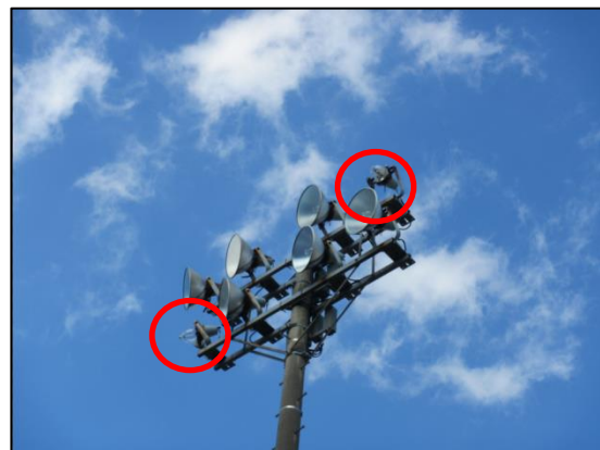
写真 20 照明器具の落下 (安平町追分柏が丘)
