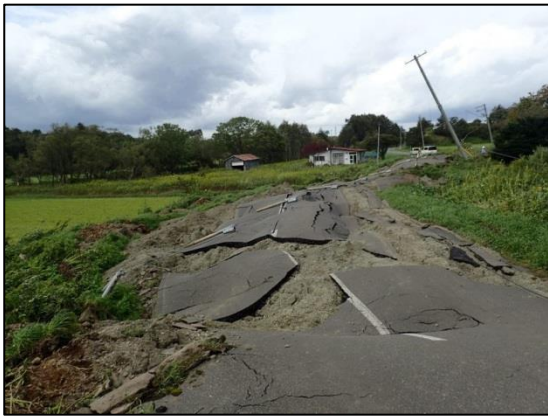
写真 32 道路破損 (厚真町幌里) (北海道開発局提供)
