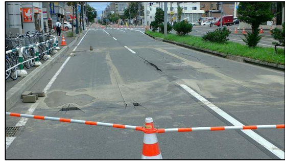
写真 55 幹線道路の損傷 (札幌市東区)
