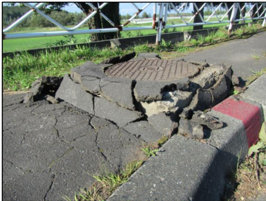
写真 15 マンホールの浮上 (安平町早来大町)
