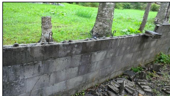
写真 37 ブロック塀の崩落 (平取町振内町)
