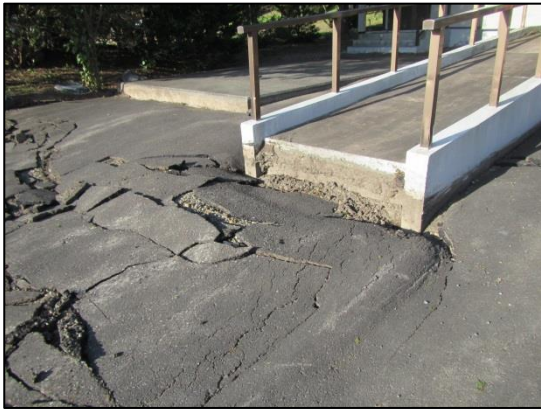
写真7 スロープ前の地割れ (厚真町鹿沼)
