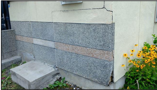
写真 56 住家壁面のひび割れ (札幌市東区)
