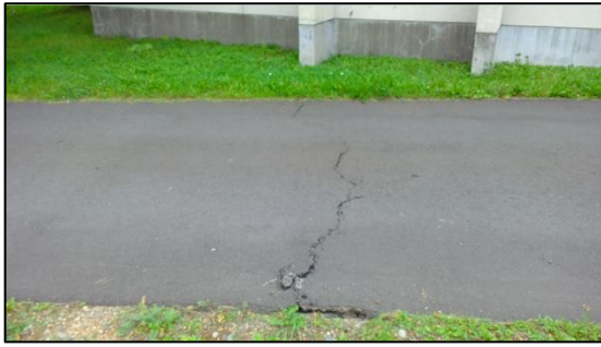
写真11 町道の亀裂 (厚真町京町)
