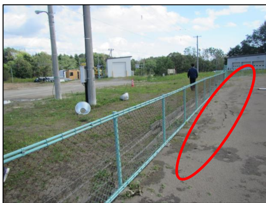
写真 19 グラウンド地割れ (安平町追分柏が丘)
