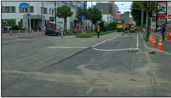
写真 54 幹線道路の損傷 (札幌市東区)
