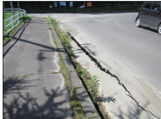
写真 35 道路亀裂 (安平町中安平橋付近)
