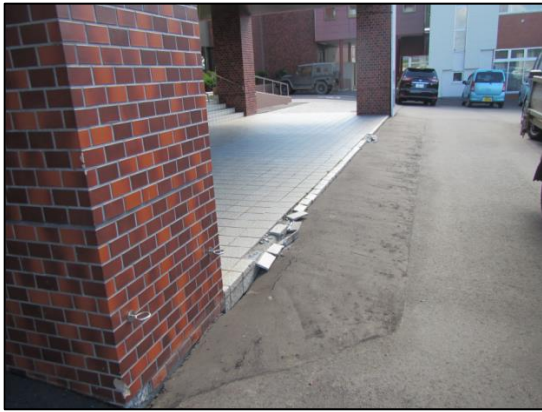
写真 17 玄関タイル剥離 (安平町早来大町)
