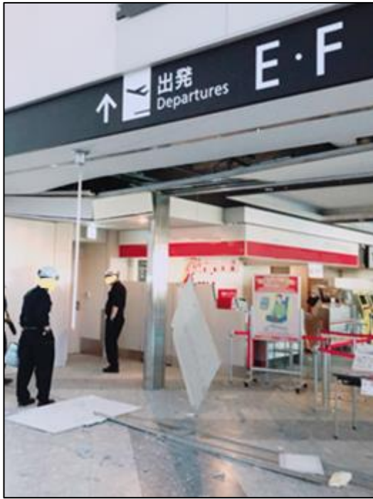
写真 43 天井部材の落下
