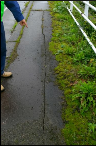
写真 38 道路の亀裂（平取町振内町）
