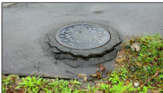
写真 39 マンホールの亀裂 (日高町富川南 2 丁目)
