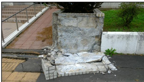
写真9 花壇壁の崩落 (厚真町京町)
