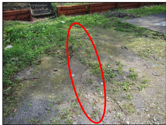
写真 18 地面の地割れ (安平町早来大町)
