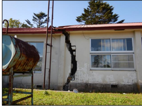
写真4 建物の亀裂 (厚真町鹿沼)
