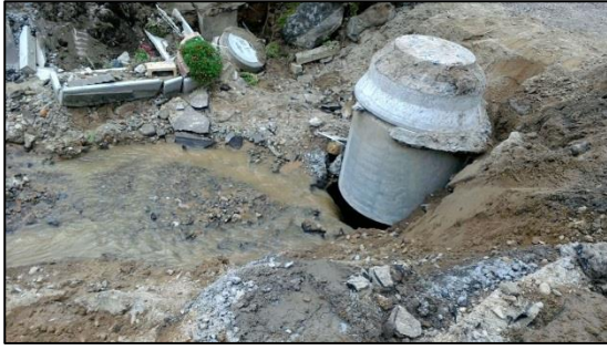
写真 57 市道の損壊 (札幌市清田区里塚)
