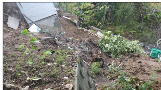
写真 65 住居裏庭・ブロック壁の滑落 (北広島市大曲並木) (北広島市提供)
