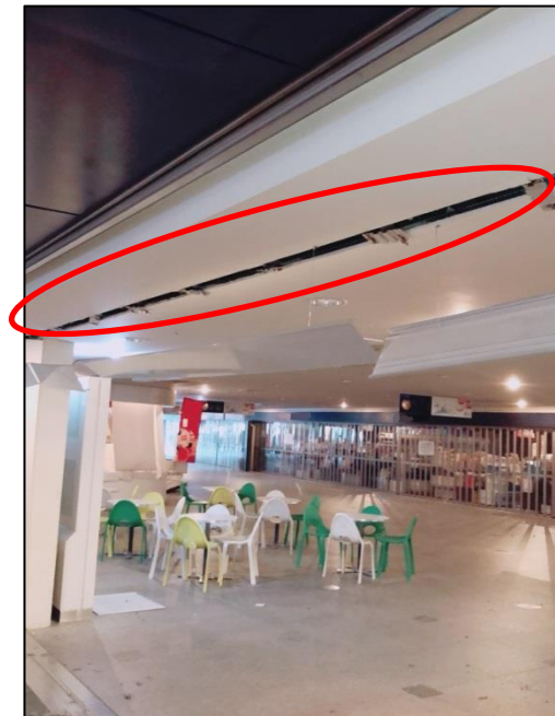
写真 46 天井部材の落下
