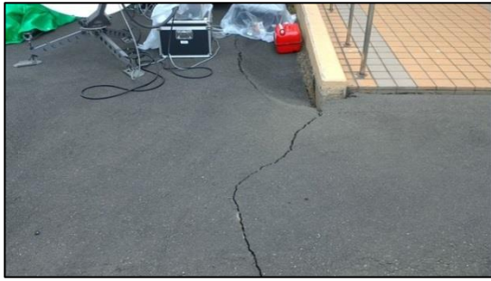
写真 23 スロープ下のひび割れ (むかわ町美幸)
