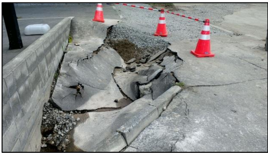
写真 61 市道の陥没 (札幌市清田区里塚)
