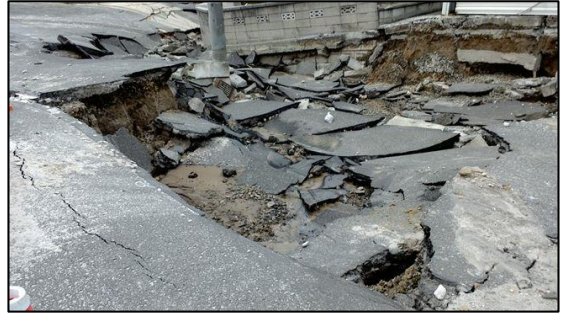
写真 58 市道の損壊 (札幌市清田区里塚)
