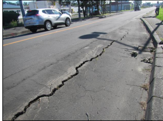
写真 16 道路の地割れ (安平町早来大町)
