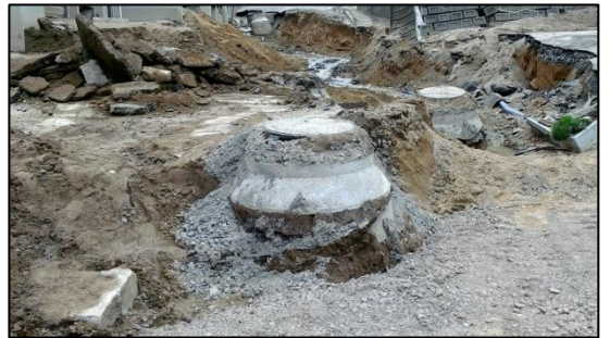
写真 60 市道の損壊 (札幌市清田区里塚)
