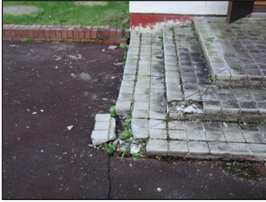
写真 13 階段崩れ (安平町早来北進)
