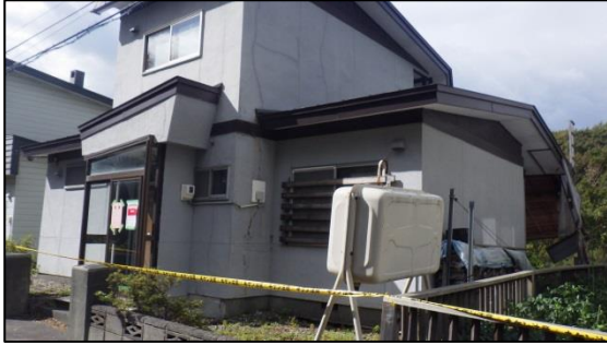
写真 62 住居損傷 (北広島市大曲並木) (北広島市提供)
