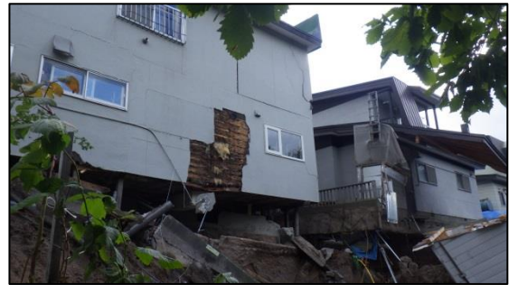
写真 63 裏壁崩落による住居損傷 (北広島市大曲並木) (北広島市提供)
