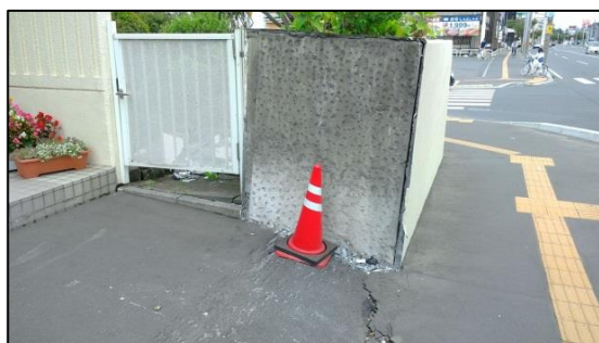
写真 52 塀の傾き (札幌市東区)
