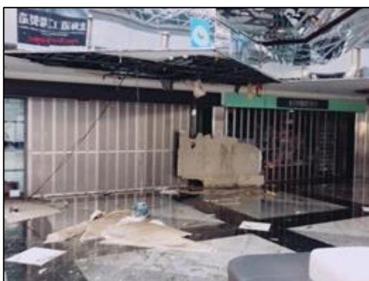
写真 41 天井部材の落下
