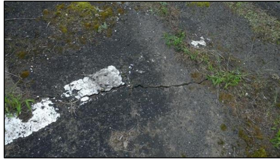
写真 27 駐車場の亀裂 (むかわ町穂別)
