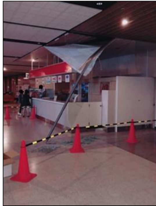
写真 44 天井部材の落下
