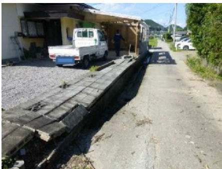
倒壊したコンクリートブロック塀 (宮崎県日向市 9/18 気象台職員撮影)
