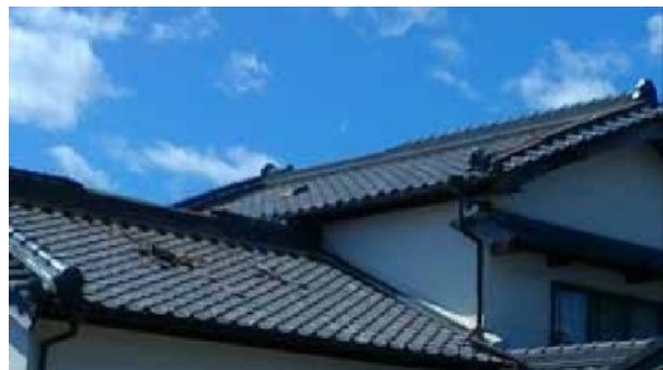
屋根瓦が飛散した住家 (高知県香南市 9/18 気象台職員撮影)
