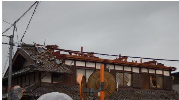
小屋組の構成部材が飛散した住家 (滋賀県米原市 6/29 撮影 気象台職員)
