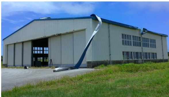
屋根ふき材が飛散した空港格納庫 (沖縄県国頭郡伊江村 6/17 撮影 気象台職員)
