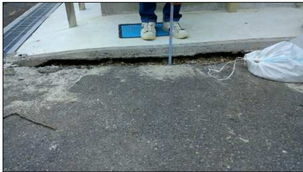
写真 5 アスファルト面の陥没 (湯梨浜町龍島)
