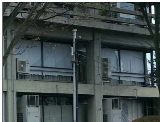
写真 4 市役所の窓ガラス破損 (倉吉市葵町)
