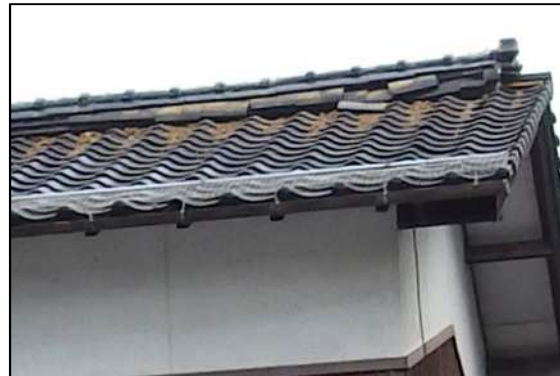
写真 6 屋根瓦のずれ (湯梨浜町龍島)
