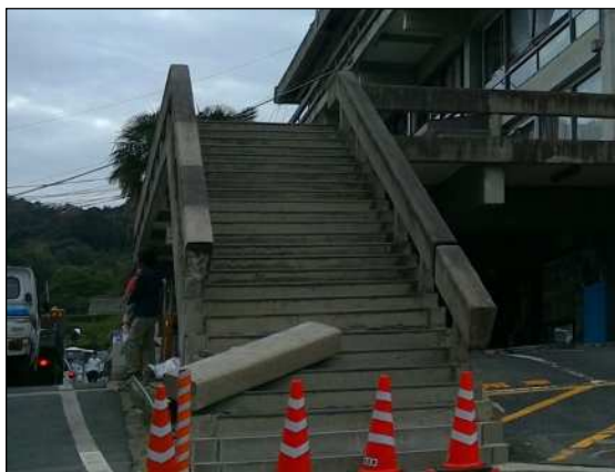
写真 3 市役所のコンクリート製手すりの落下 (倉吉市葵町)
