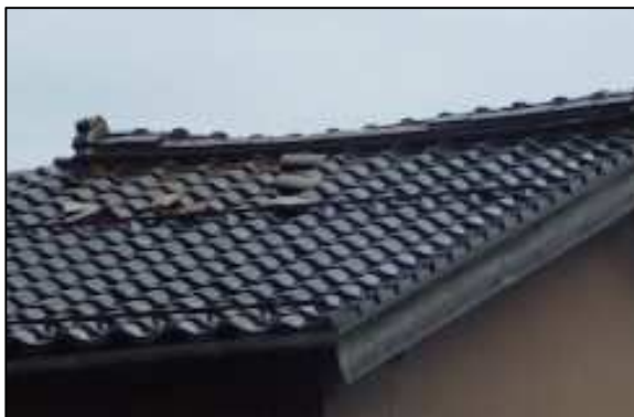
写真 7 屋根瓦のずれ (北栄町由良宿)
