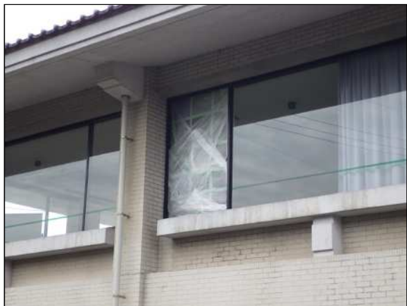
写真 8 商工会議所の窓ガラス割れ (北栄町由良宿)
