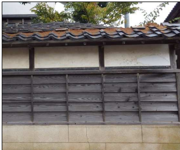
写真 10 住家の瓦落下、壁のひび (鳥取市青谷町青谷)
