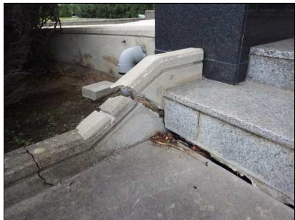
写真 2 建物基礎部分の亀裂 （北栄町土下）
