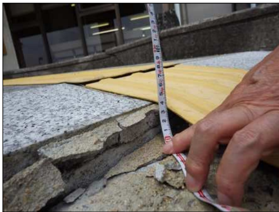
写真 1 歩道の陥没 （北栄町土下）
