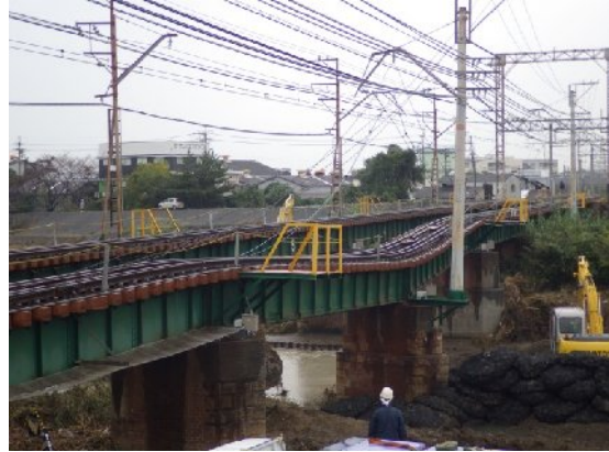
大阪府阪南市男里川橋梁の被害 (10/28 気象台職員撮影)
