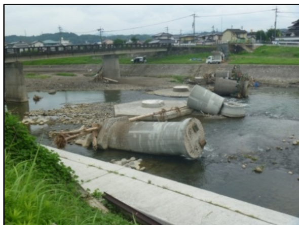
花月川 ( 大分県日田市 ) にかかる JR 久大本線の橋梁の流出 ( 8/10 気象台職員撮影 )
