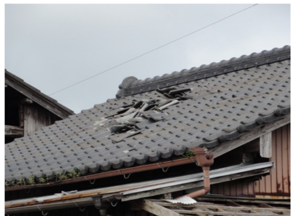
屋根瓦が一部はがれた住家 (鹿児島県南九州市 7/7 気象台職員撮影)
