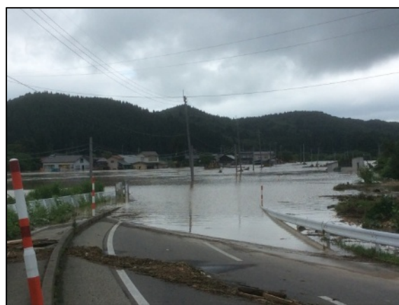
秋田県大仙市協和下淀川地区の被害 （秋田県提供（7/23撮影））
