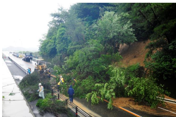
熊本県上天草市の道路法面崩壊 (提供：上天草市)
