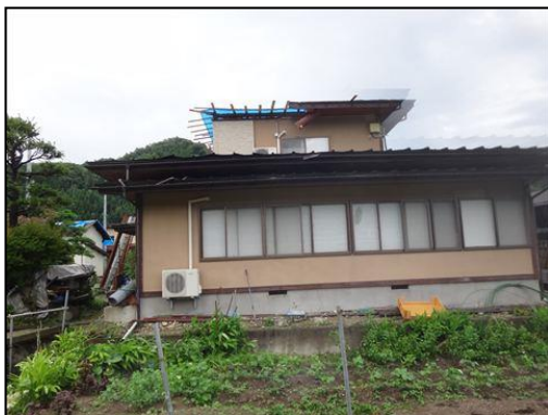
屋根の一部が剥離・飛散した住家（7/22 山形県山形市） （図表中の番号：⑩）
