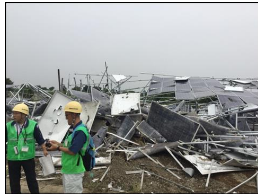
倒壊した太陽光発電施設（6/15 群馬県伊勢崎市） （図表中の番号：③）
