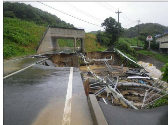
④ 路面崩壊: 県道 300 号跡市波子停車場線 (江津市)
