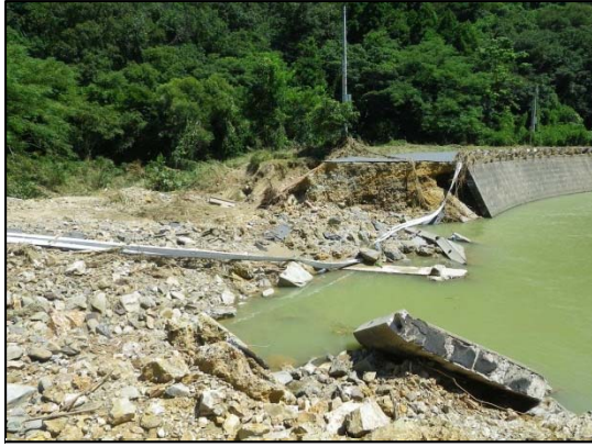
① 道路流失: 県道 299 号下府江津線 (江津市)
