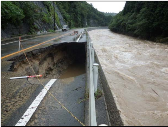
③ 路面陥没: 国道 261 号 (邑南町)
