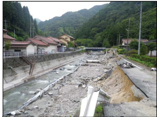
⑥ 護岸崩壊 (江津市)
