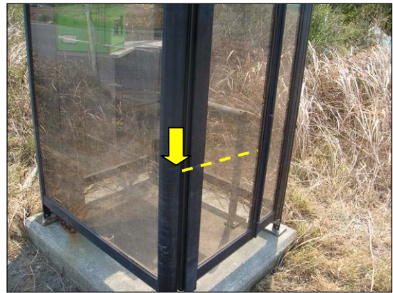
写真 11 津波の痕跡（図 16 の 57）
