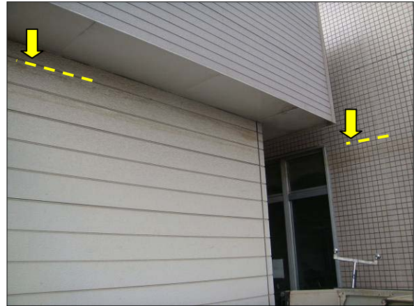
写真 6 津波の痕跡（図 13 の 55）
