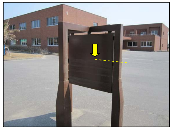
写真 14 津波の痕跡（図 17 の 58）
