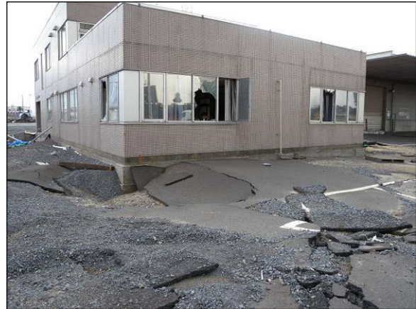
写真 8 鹿島港南公共埠頭内の状況
