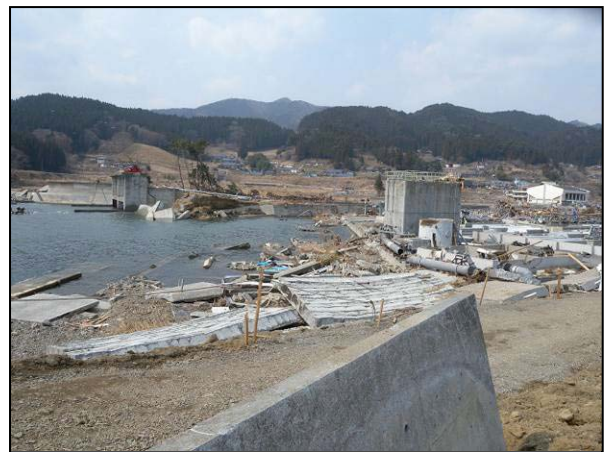
写真 12 津波により破壊された岸壁
