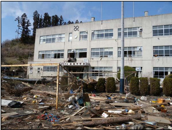
写真 28 校舎の被害状況
