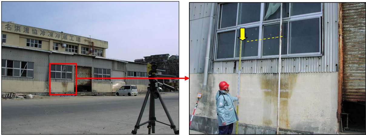
写真 47 津波の痕跡（図 29 の 45）
