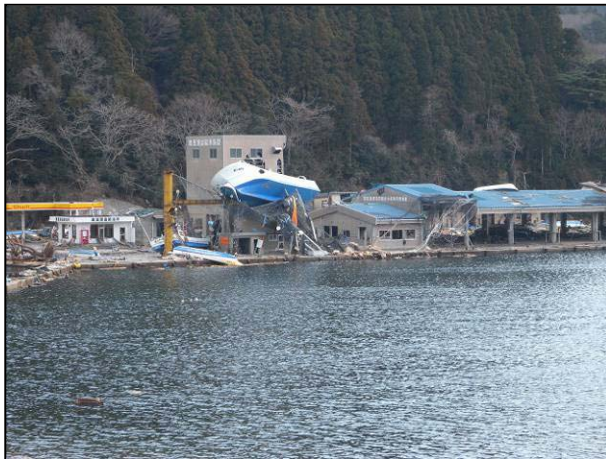
写真 20 漁港外側の漁協施設の被害状況
