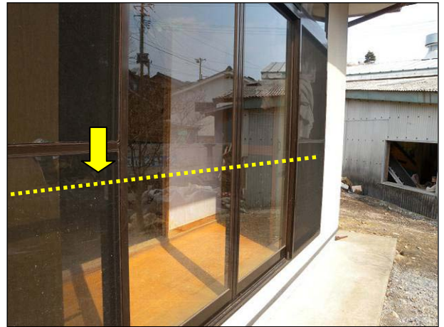
写真 24 津波の痕跡（図 13 の 33）
