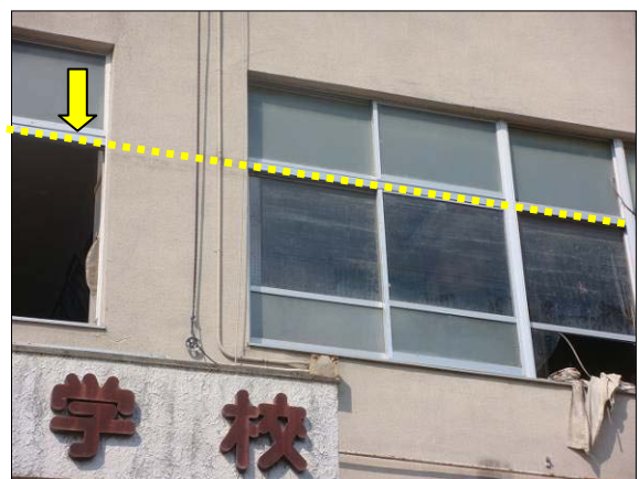
写真 27 津波の痕跡（図 14 の 34）
