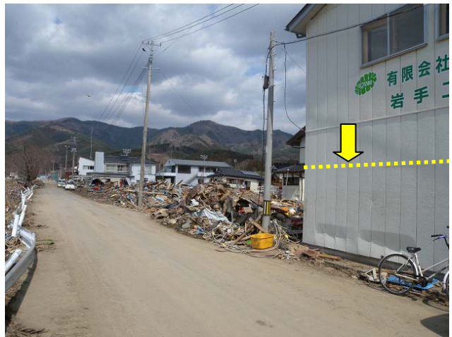
写真 19 津波の痕跡（図 12 の 32）
