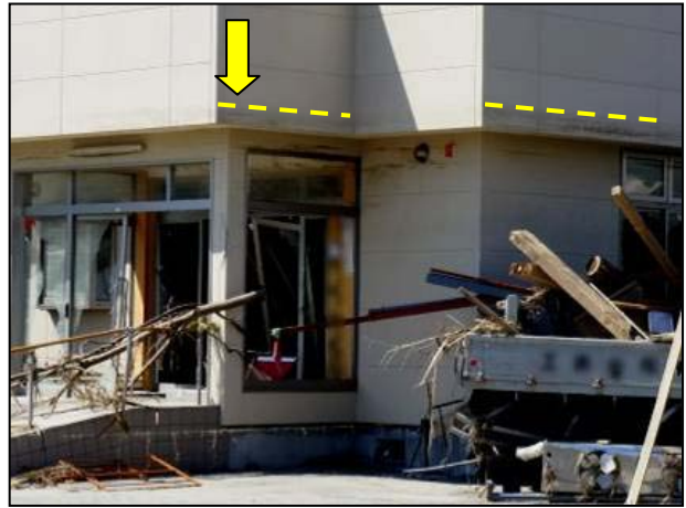
写真 34 津波の痕跡（図 19 の 37）
