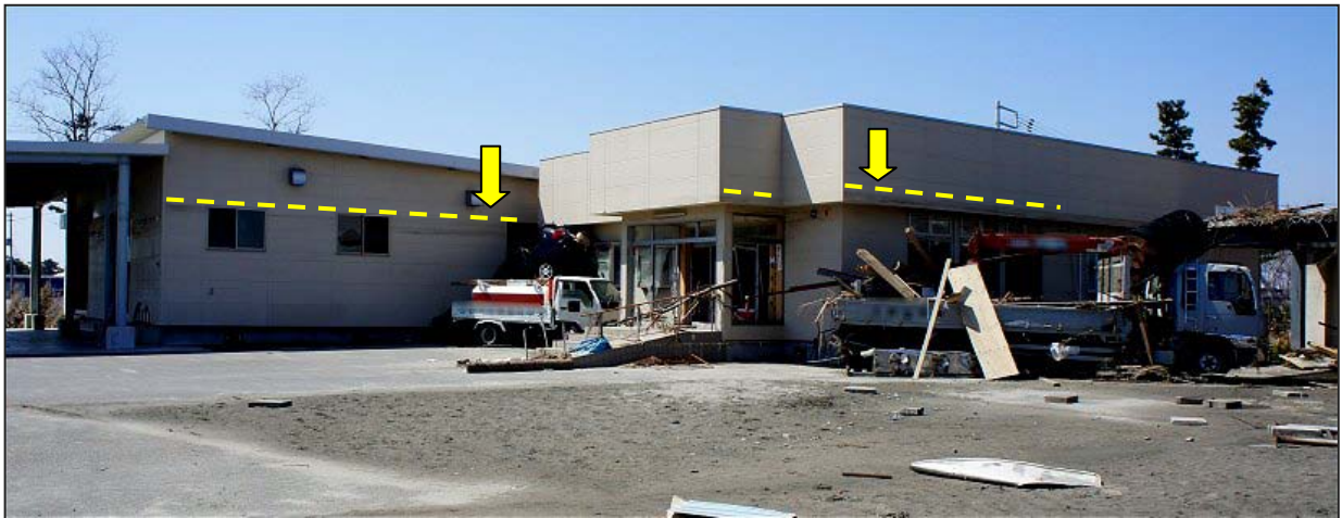
写真 35 津波の痕跡（図 19 の 37）
