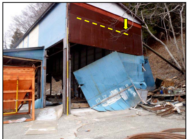
写真8 津波の痕跡（図7の28）
