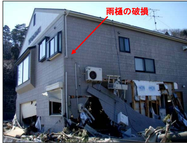
写真 37 津波の痕跡（家屋の雨樋の破損、図 21 の 39）
