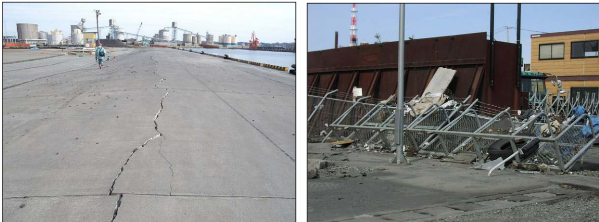
写真 46 小名浜検潮所の周囲の状況 岸壁の亀裂や隆起などの被害が広い範囲で見られたほか、 フェンス類も多数損壊していた。
