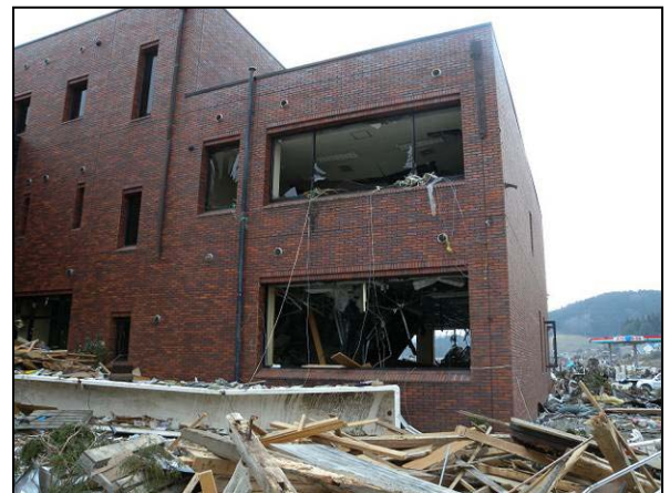
写真 14 2階まで浸水した公民館
