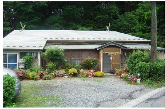
震度観測点の北西約150mにある神社の社務所の外観。室内の置物の一部が転倒したが、建築後約100年が経つという建物に被害は見られない。
