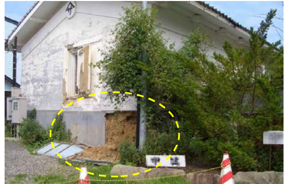
震度観測点北約200m付近の土蔵。外壁が一部崩れ、亀裂も複数見られる。
