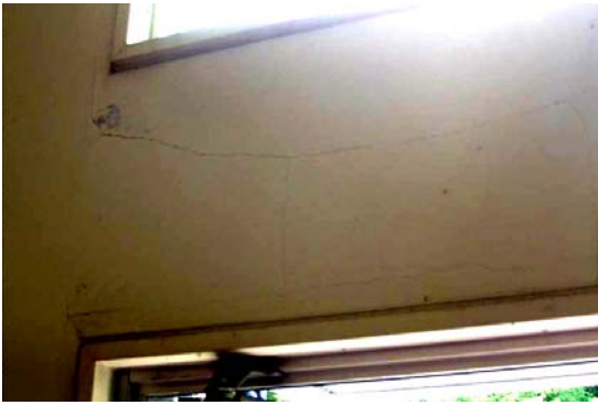
震度観測点の西約50mにある消防署の内部。1階車庫の南西側壁面に、長さ約2mの亀裂が入っている。
