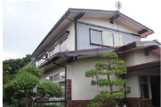
震度観測点の南西側約100mの民家。2階の窓の鍵が外れ、ベランダに落ちた。1階ガラス障子のガラスが割れ、網戸が外れた。風呂のタイルが8枚剥がれた。(築30年)
