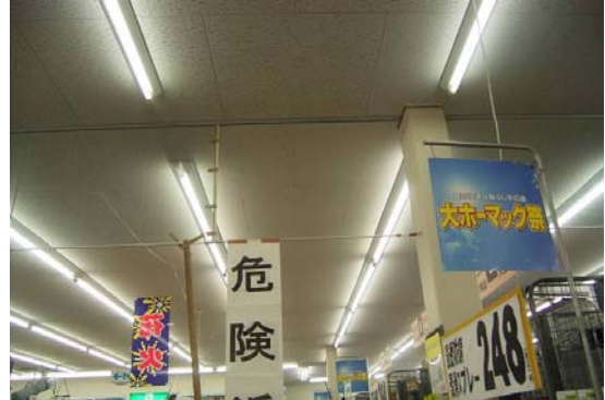
震度観測点の南約200mにある店舗（ホームセンター）内部の状況。仕切りにはめ込まれていたガラスにひびが入ったため取り除かれている。柱と天井パネルの間に隙間が生じている。
