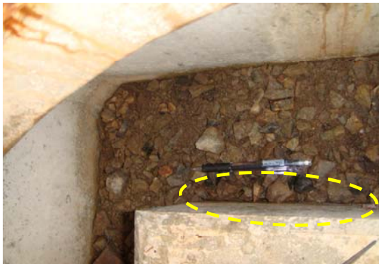
④ 震度計基礎と地面との隙間。基礎台と 土砂、囲いと土砂の双方に数 mm の隙 間が見られる。
