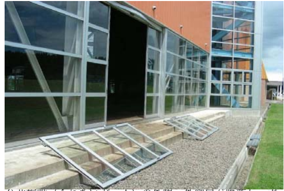
公共施設（ふれあいドーム）の外観。外側扉が脱落し、ガラスが破損している。
