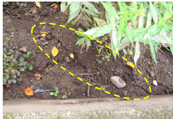
⑤ 段差の部分には地割れが見られる。
