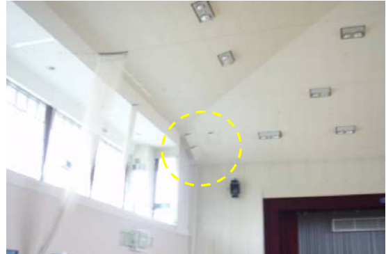
写真56 一関市室根町 [岩手県]
