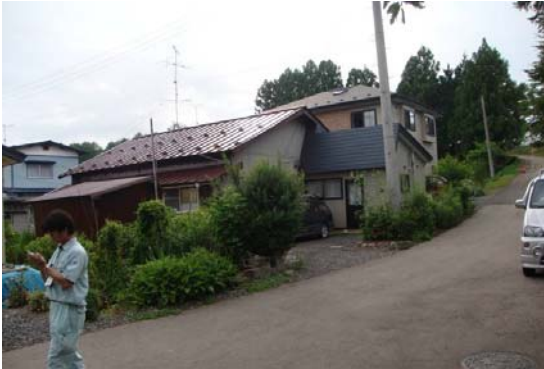
震度観測点の西側約100mの民家。額縁、時計、仏壇や神棚の小物、金魚鉢が落ちた。ガラス障子が閉まりにくくなった。建物に目立った被害なし。(築50年)
