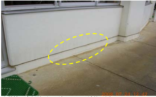
小学校の南側壁面の下部に、ひび割れが生じている。
