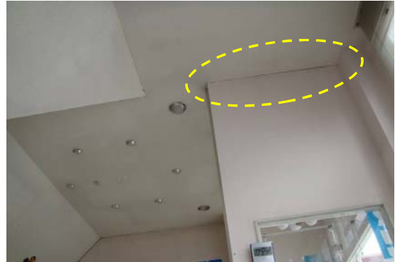
左店内1階内装の石膏ボードのつなぎ目にずれ。
