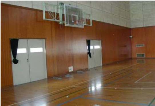
震度観測点の南西約200mにある体育館内部の状況。天井の一部が破損し、コンクリート片が床に落下している。
