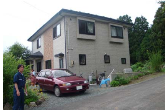
震度観測点の西側約100mの民家。食器棚、冷蔵庫が5〜6cmずれた。壁に20箇所ひびが入った。建物の外壁には目立った被害なし。(築5年)
