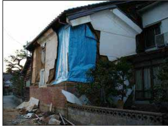
写真 (No.6) 土蔵の壁の崩壊
