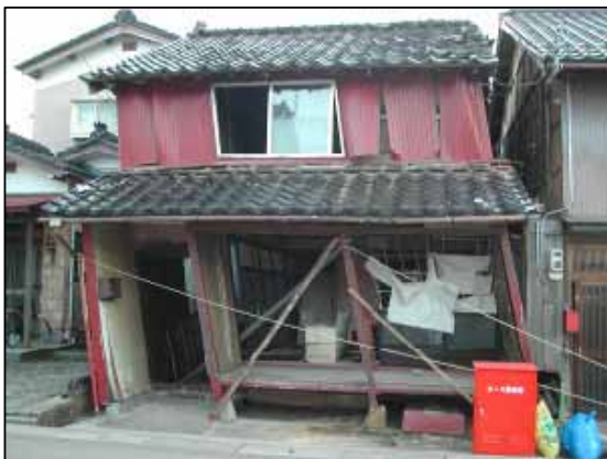
写真 (No.1) 1 階部分が崩壊し家全体が傾いている
