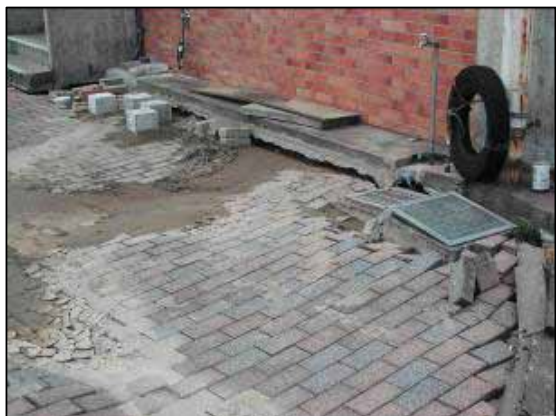
写真 (No.1) 七尾市役所田鶴浜支所のタイル舗装の沈下
