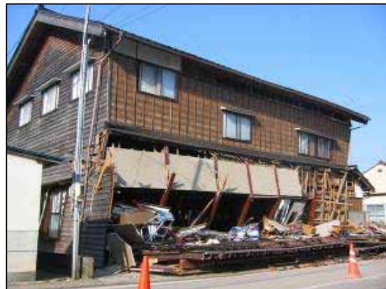
写真 (No.2) 崩壊した家屋
