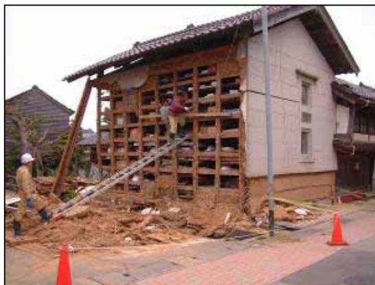
写真 (No.2) 土蔵の壁の崩落
