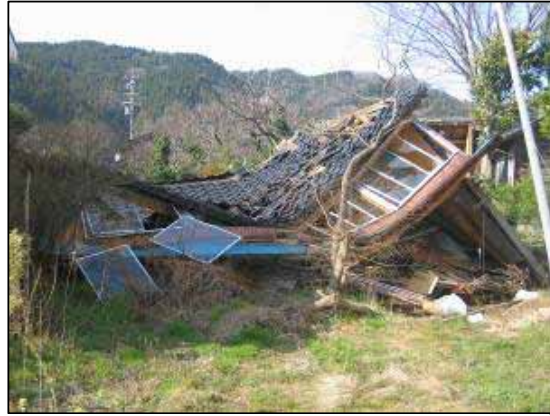
写真 (No.4) 全壊した家屋
