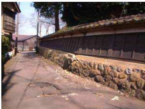
写真 (No.7) 塀の基礎部分の崩壊
