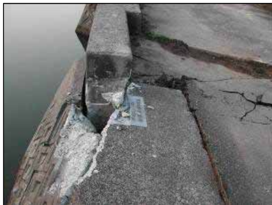
写真 (No.2) コンクリート舗装の落下
