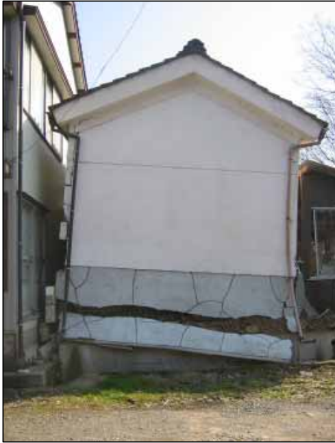
写真 (No.3) 一部崩壊した土蔵
