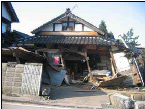
写真 (No. 1) 崩壊した家屋
