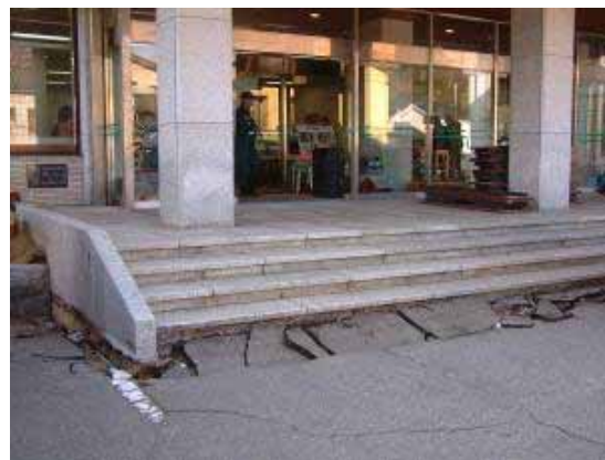
写真 (No.8) 輪島市役所門前総合支所玄関前の舗装部分が下がり亀裂が生じている。
