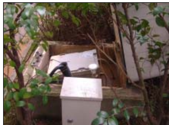
写真 震度計設置環境 液状化により震度計台が傾いている
