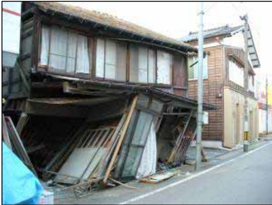
写真 (No.5) 1 階部分が崩れ
