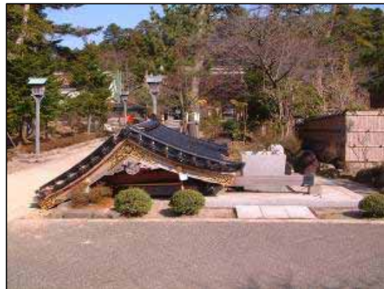
写真 (No.6) 柱部分が折れ倒壊した寺院の建物
