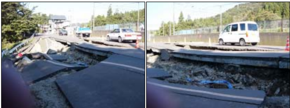
写真 2-12 道路の崩落（崩落した道路の長さは約 50m で落差は約 2m）
