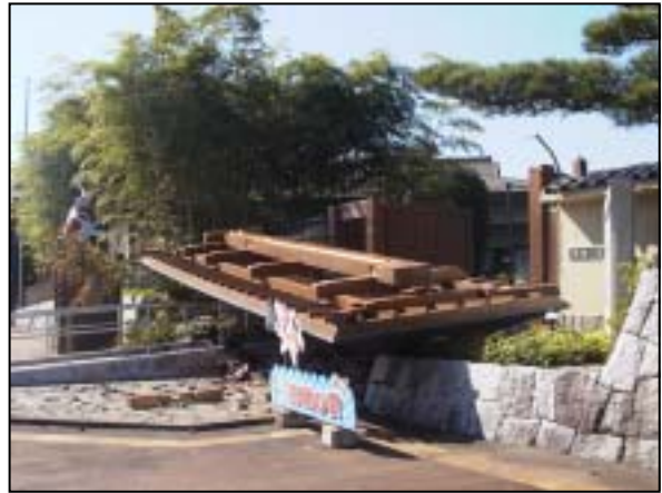
写真 2-6 屋根が落下した門（図 2-2-2 の No. 4）
