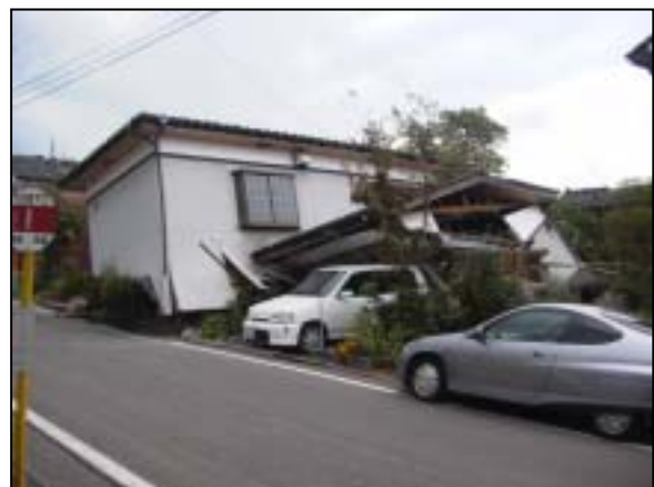
写真 2-19 倒壊した家屋
