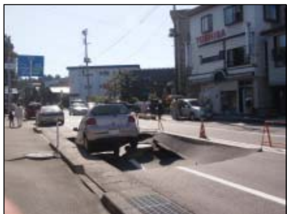
写真 2-4 道路上の陥没箇所（陥没は深さ 50cm 長さ 7m50cm 程度。図 2-2-2 の No. 2） 【小千谷震度観測点から約 250m】
