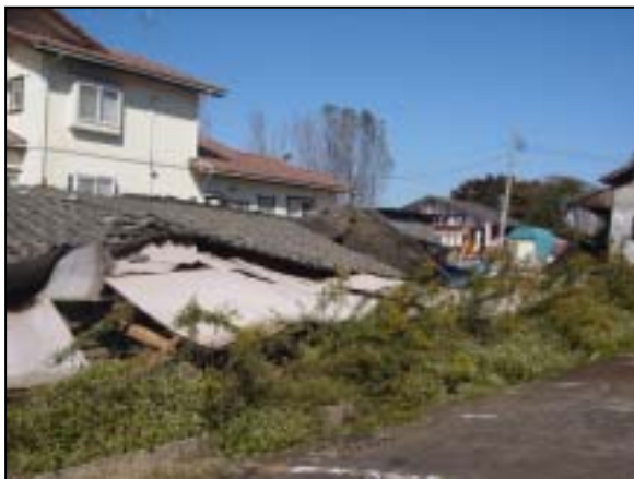
写真 2-3 全壊した手前の家屋と外見上被害が見られない後ろの家屋（図 2-2-2 の No. 1） 【小千谷震度観測点から約 100m】
