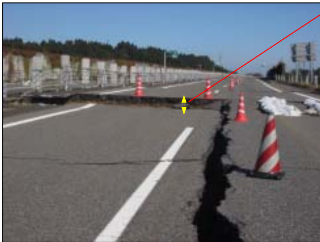
写真 2-1 小千谷 IC 付近の高速道路上の段差、亀裂
