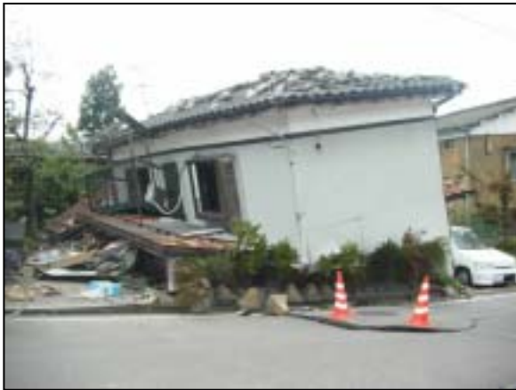
写真 2-20 1 階部分が潰れた家屋
