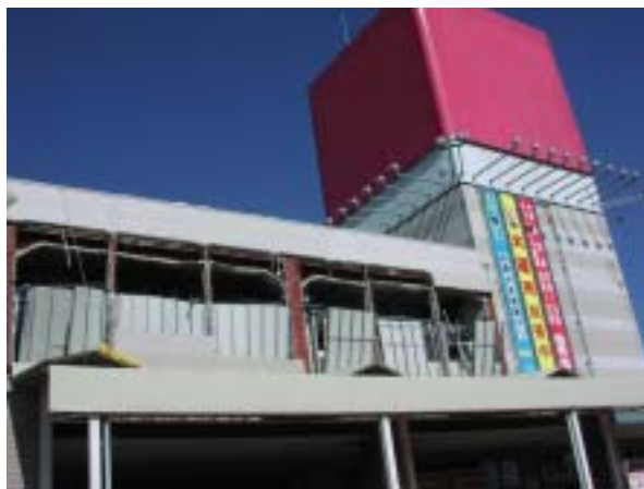
写真 2-7 横壁が剥離し、立入り禁止となった店舗 （図 2-2-2 の No. 5）
