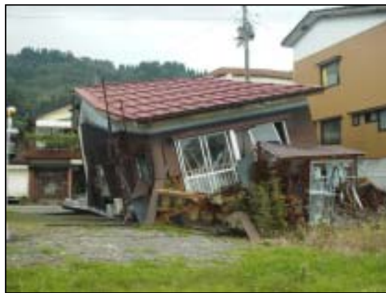
写真 2-29 基礎部分が潰れ倒壊した家屋 (図 2-2-5 の No. 6)
