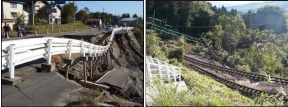
写真 2-13 道路・鉄道の崩落（国道 17 号と JR 上越線）
