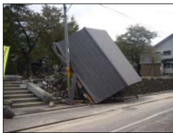
写真 2-31 柱部分が折れ倒壊した寺院の建物 (図 2-2-5 の No. 7)
