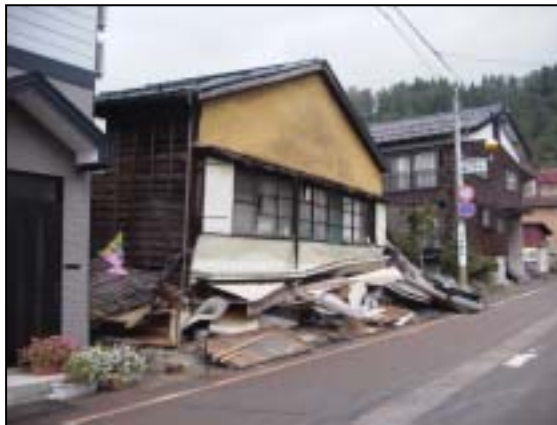
写真 2-26 1階部分が潰れた家屋 （図 2-2-5 の No. 3）
