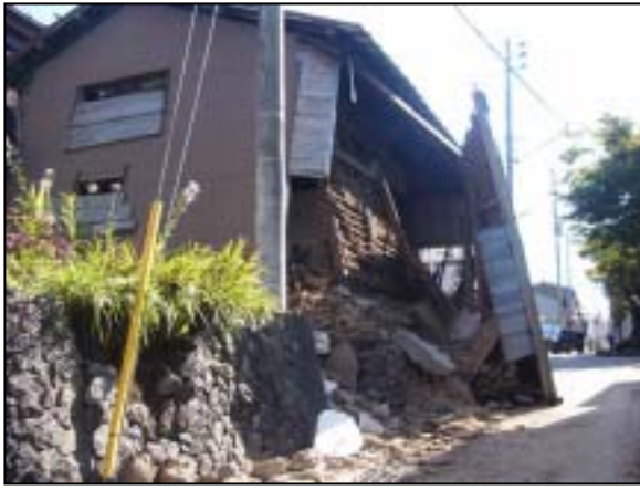
写真 2-5 壁が剥離した倉庫（図 2-2-2 の No. 3）
