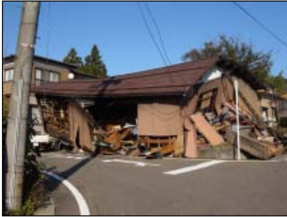
写真 2-14 倒壊した家屋
