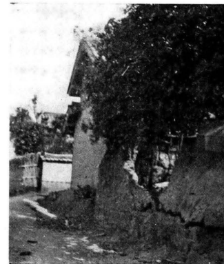
(12) 廣瀬村林口の土塀(厚さ 30 cm, 高さ約 1.5m, 長さ 3m) 西側へ崩落。
