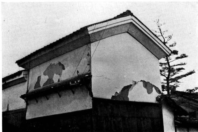
(9) 柏原町小川沿ひの土藏の破損
