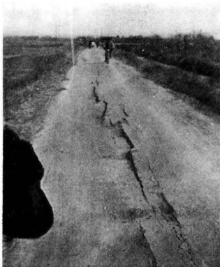
(10) 瀬南村と百濟村との境、葛城川西側堤防上の龜裂。
