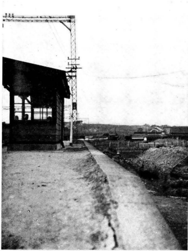
(1) 大阪鐵道上太子驛ホーム に龜裂を生じ内側沈下す
