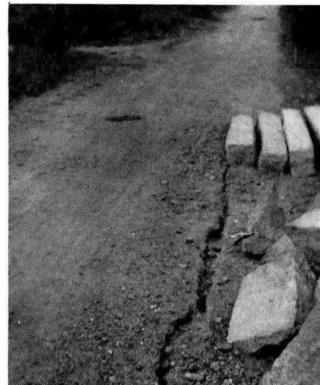
(17) 矢田村外川富雄川西側堤 防上の龜裂。
