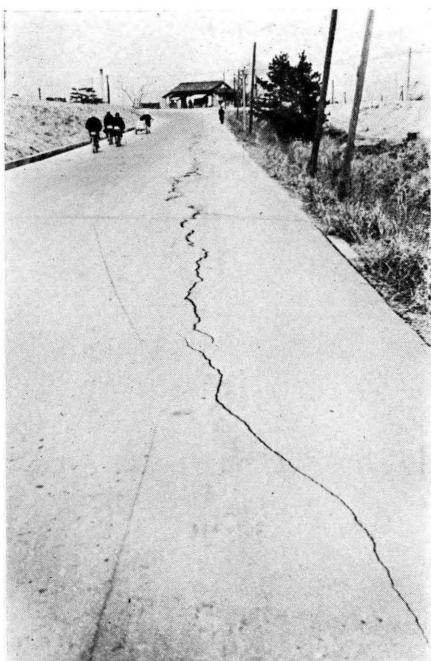
(6) 大和川沿ひの奈良街道柏原道明寺間のアスファルト道路上の横の龜裂
