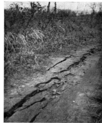
(9) 廣瀬村廣瀬西外れ葛城川東側堤防上の地裂 (幅 10cm)。
