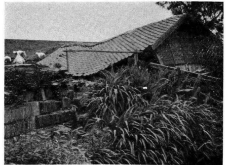
( 4 ) 静岡市森下町 ( 5 ) 柿木附近に於ける舗装道路の龜裂 ( 6 ) , ( 7 ) 古庄, 全潰せる人家
