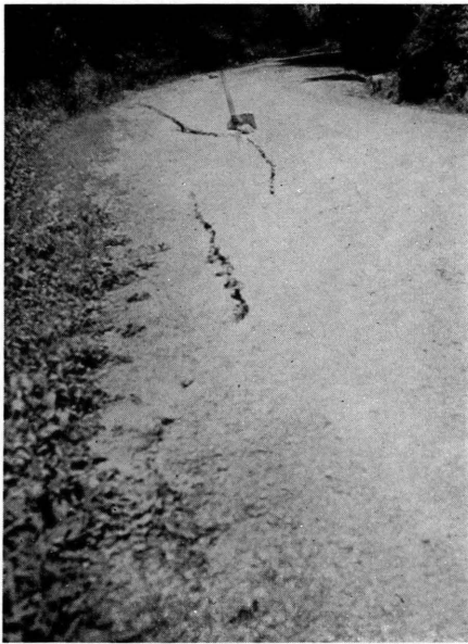
相生村地内道路の龜裂。
