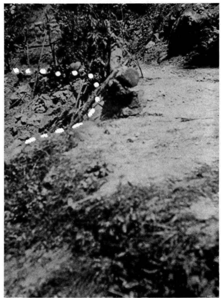
相生村箱坂附近、山腹より岩石落下し 道路を破壊せる跡、(白點内)、此の下 の川原にて落石の爲一名重傷。
