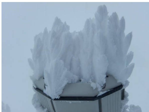
図 19：ハウジング表面の突起凹凸部分から樹氷が成長していく様子(2016/02/24撮影). ハウジング③の前面を下から撮影.
