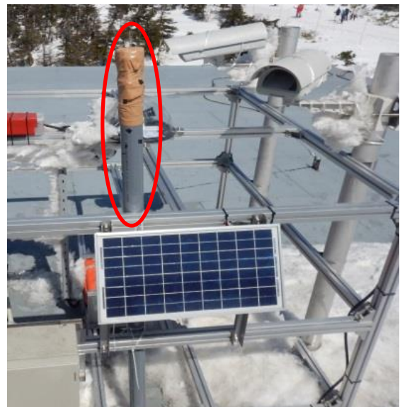
図 11：外気温測定センサーの設置位置（2016/1/29 以降）。塩ビパイプ中にセンサーを設置し、パイプ上部に空気循環用の穴をあけた。
