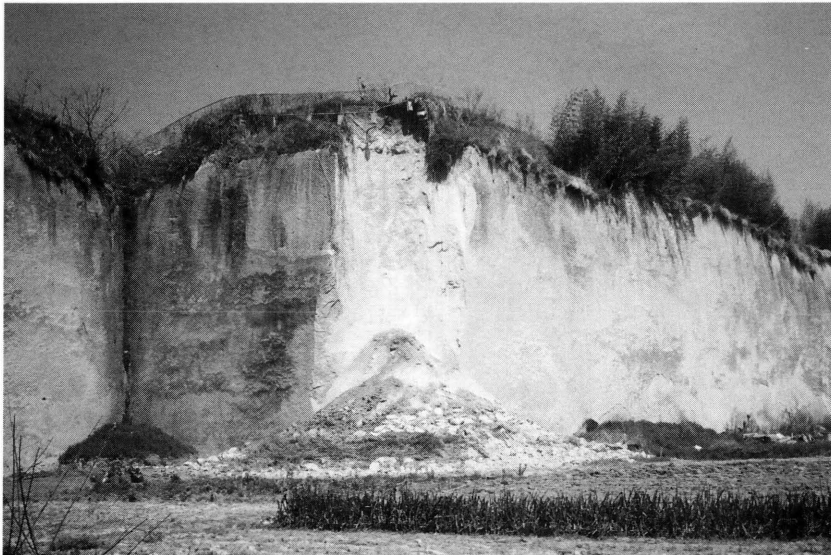
水俣市田子の須（古城3丁目） 付近の崖（シラス）崩れ（No4）
