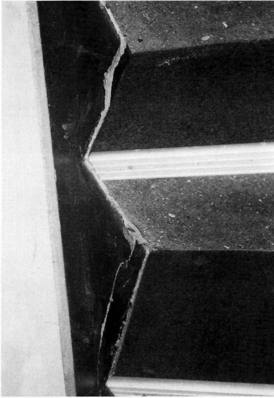
水俣市桜井町の食堂の階段（2F～3F）の亀裂（No16）
