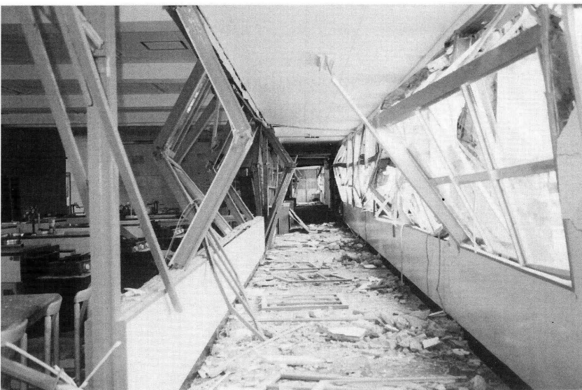
宮之城高校2号館の内部の破損状況 (No53)
