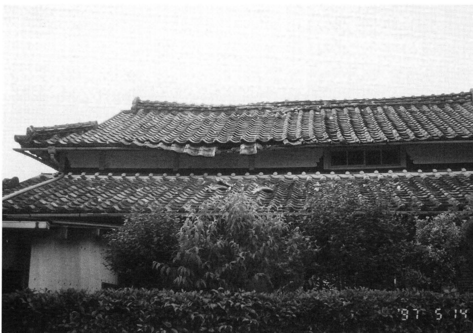
水俣市浜田2丁目の民家屋根の瓦（15枚）落下（No9）
