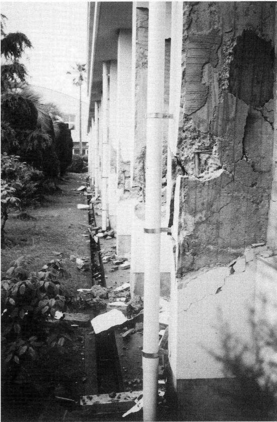
宮之城農業高校第1校舎コンクリート柱の破損 (No92)
