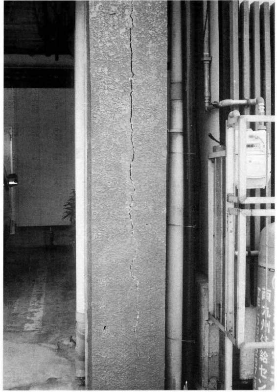
水俣市桜井町の食堂のコンクリート柱の亀裂（No18）
