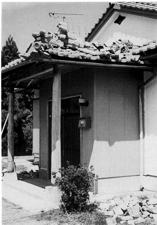
写真1：(第2図中の)②中種子町田島の民家。屋根瓦が剥がれ落ちている。
