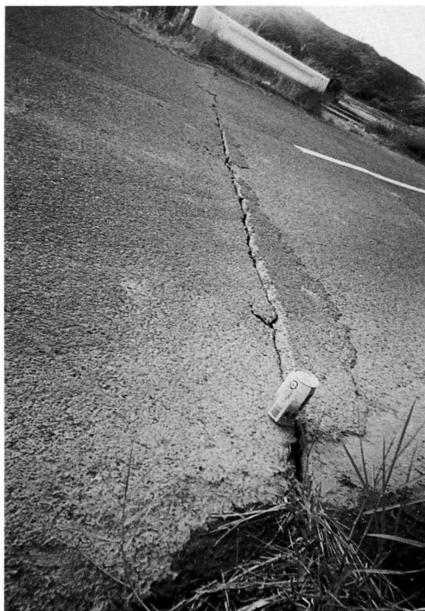
写真2：④中種子町熊野付近の県道75号線。段差は最大5 cm。
