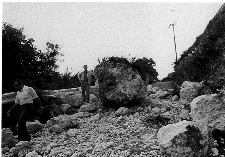
写真9. 町道池治一蒲生線道路の落石の状況 (喜界島)
