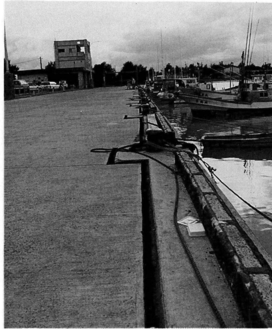
写真4. 湾港の港湾施設の被害状況（喜界島）
