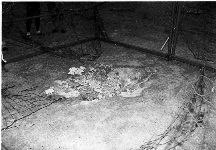
写真7. 町立第一中学校の校庭の陥没 (喜界島)
