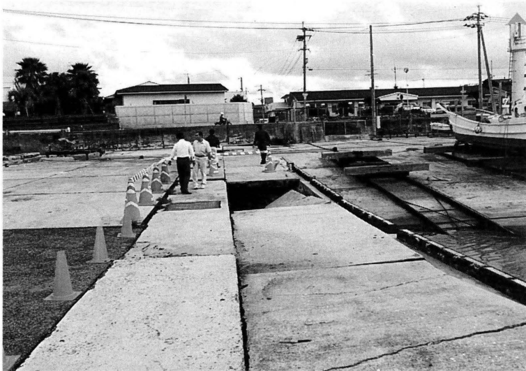
写真5. 同場所の護岸の陥没（喜界島）
