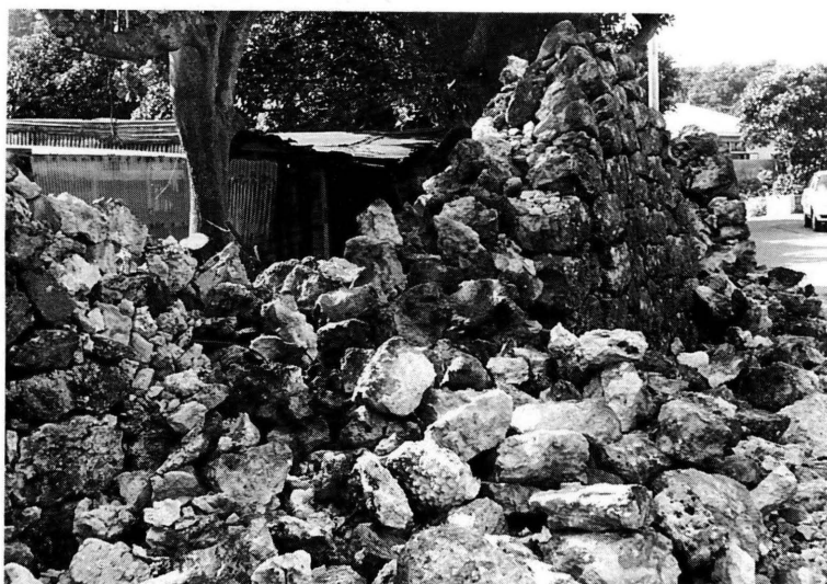
写真3. 小野津では民家の石垣が数箇所崩壊した（喜界島）
