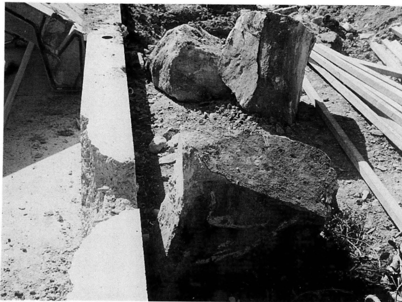
写真6 出水市大川内原地区：工事中の擁壁を落下した岩石が崩す
