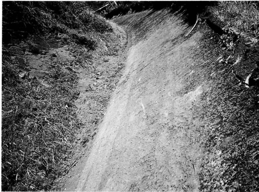
写真5 大口市田代地区：県道48号線（大口-出水間）で一部土砂崩れ
