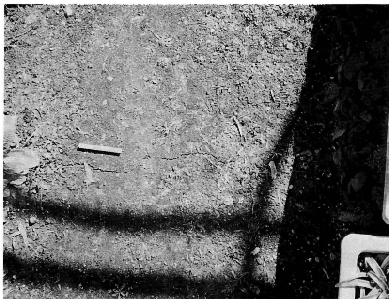
写真2 大口市田代地区：田代市営住宅前の花壇数十mに数mmのひび割れ
