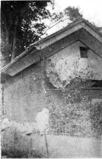
第六十圖 大寄村大字戸森土藏の壁崩落
