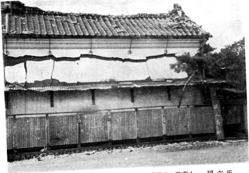
(影撮りよ東々北) (館旅屋湊上吹字村上吹)落崩の壁藏土 圖六第
