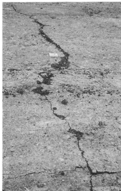
写真3 新十津川町和歌 道路に亀裂
