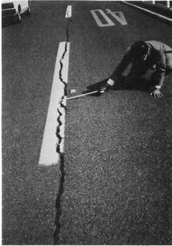
写真1 俵原の道路面の亀裂. 中央白線の長さは5 m.
