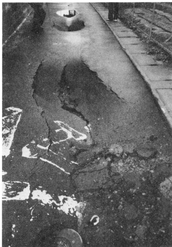
写真8 浅津の道路陥没。簡易舗装であるが陥没70cm余。面積も大きい。
